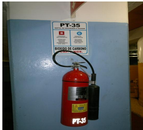
Figura 31 Extintores De Casa de Maquinas
