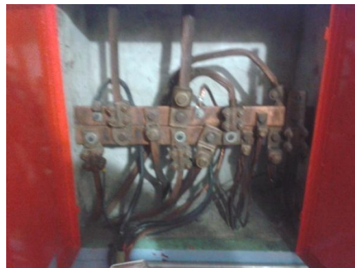
Figura 5.3 Tableros y maquinas aterrizados a tierra. En casa de maquinas
