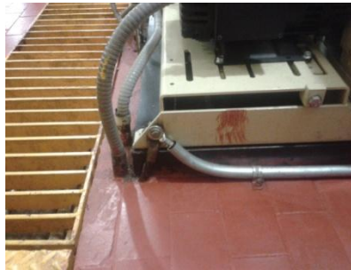
Figura 5.1 Compresor aterrizado en casa de maquinas
