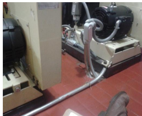
Figura 5.2 Tableros aterrizados a tierra en casa de maquinas
