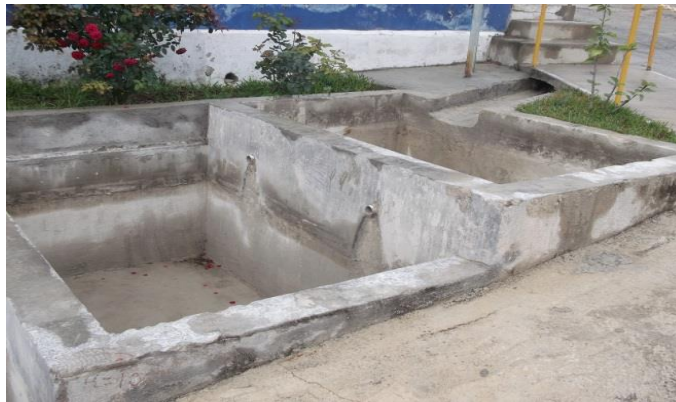
Fotografía 6.2 Tanques en desnivel para que el material lixiviado de concreto (lechada) se separe del agua a través de un proceso de decantación.
