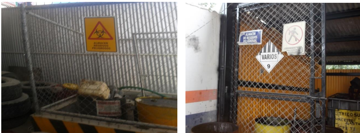
Fotografía 7.3 y 7.4 Almacén temporal de residuos peligrosos
