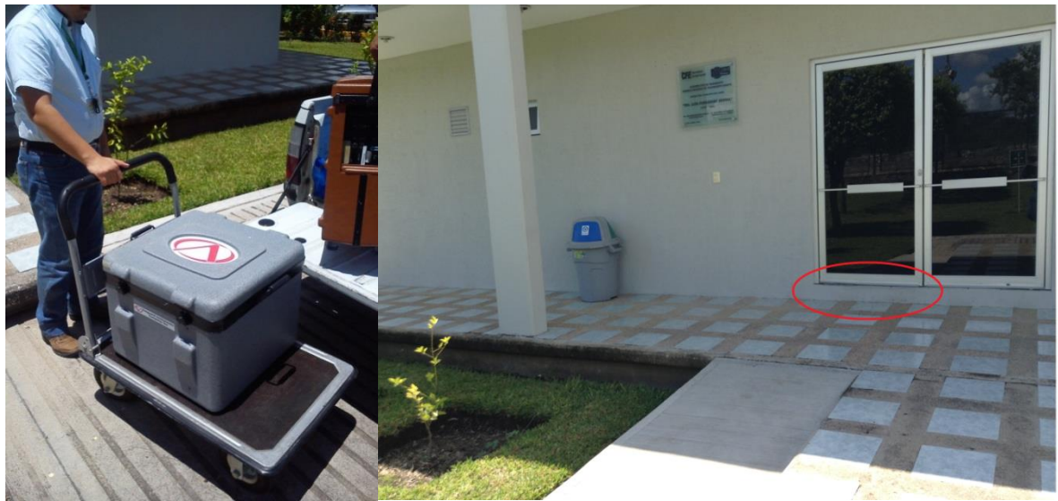
Fig. No. 5.6 Dificultades de introducción de equipos en la entrada
