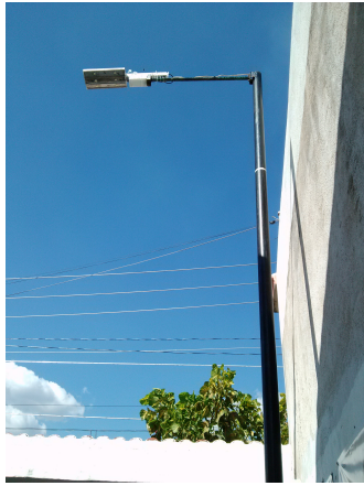
Figura 50: Lámpara instalada con prototipo en funcionamiento 2
