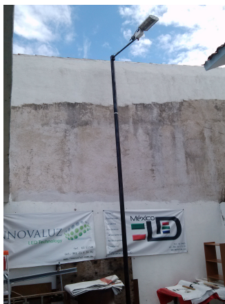
Figura 49: Lámpara instalada con prototipo en funcionamiento 1
