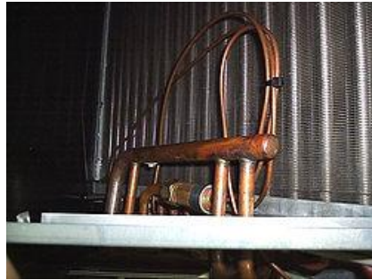
Fig. 2.8 Evaporador de serpentín aleteado al interior de equipo de aire acondicionado tipo Split (convección natural)
