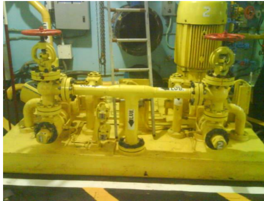
Figura 86.- Bombas y tuberías del sistema de regulación.
