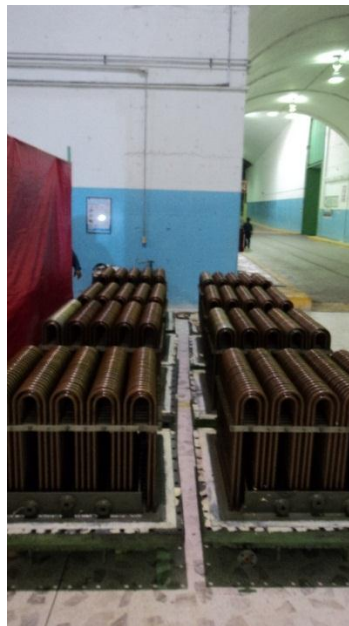
Figura 88.-Intercambiadores de calor del sistema de regulación, 8 piezas.
