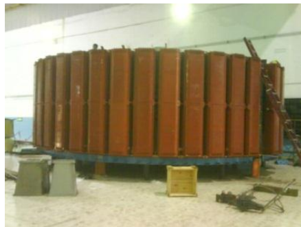
Figura 84.- Rotor con polos instalados.
