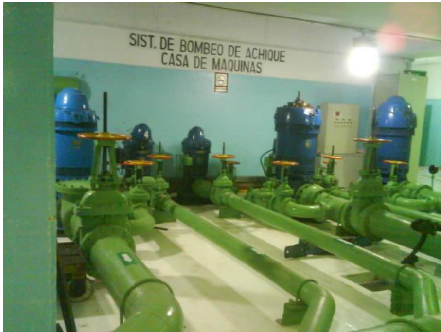
Figura 23.- Sistema de bombas de achique.
