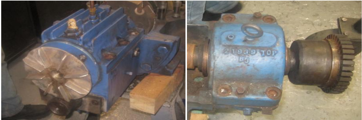
Fig.43 Zona de chumaceras lado libre y lado cople
