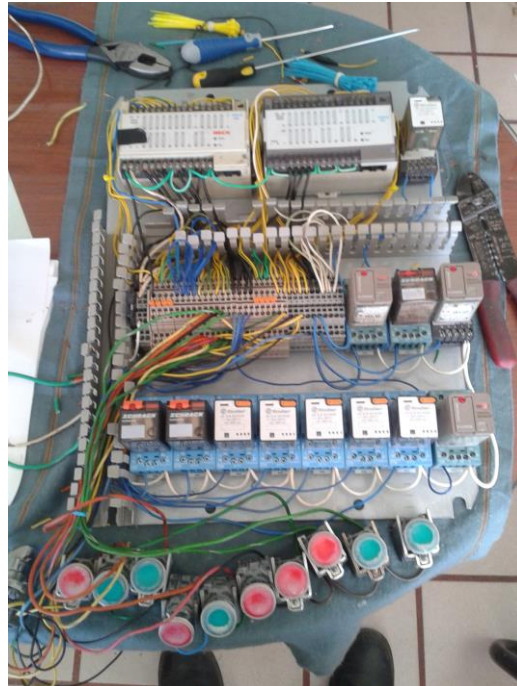
Figura 4.31 Vista final del tablero de pruebas.
