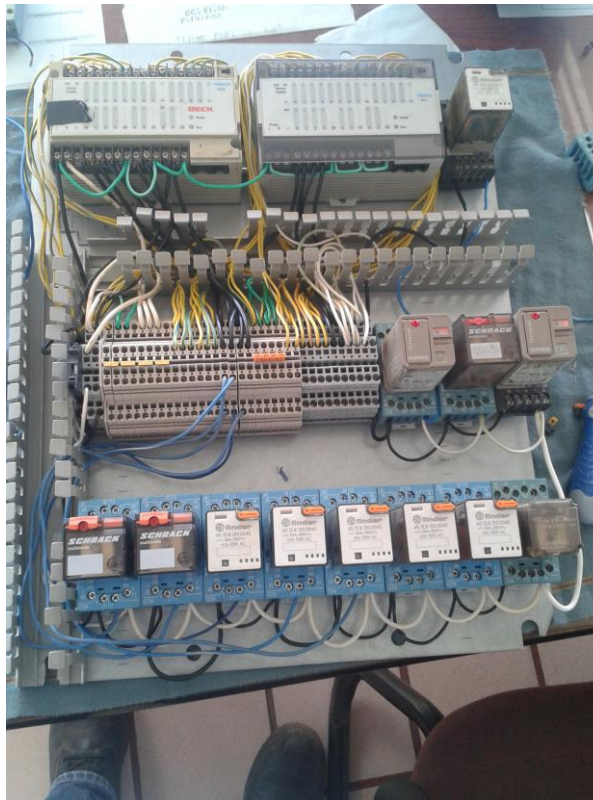
Figura 4.29 Tablero de pruebas con relevadores.
