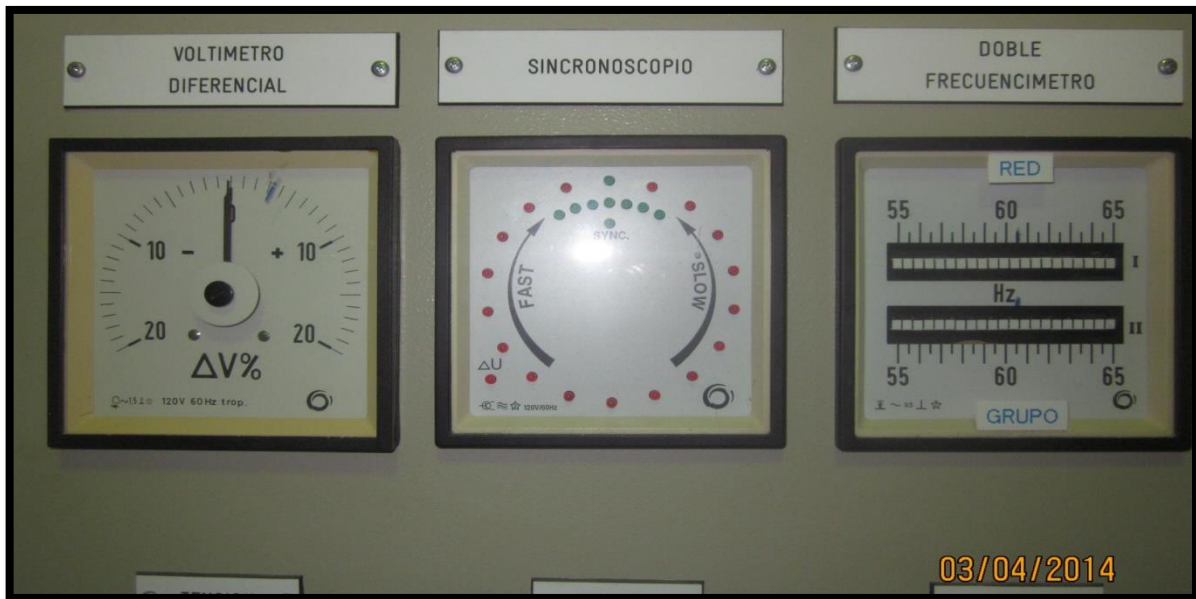
Fig. 3.27. Voltímetro diferencial, Sincronoscopio y doble frecuencímetro.
