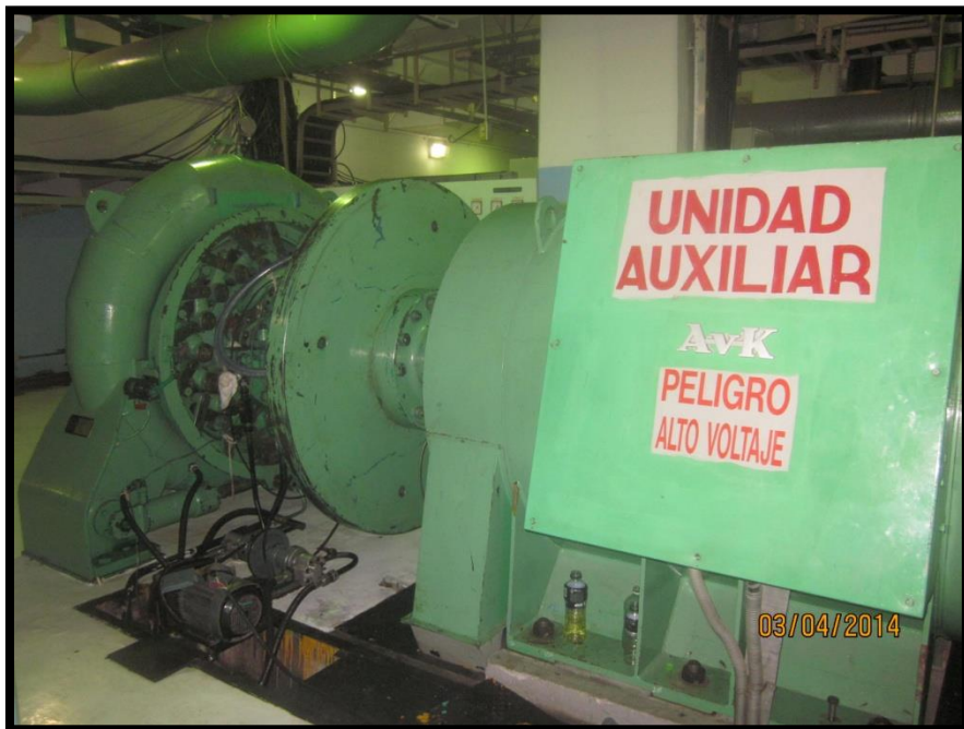
Fig. 3.19 Unidad Auxiliar; Como motor primario una turbina Francis con eje horizontal.
