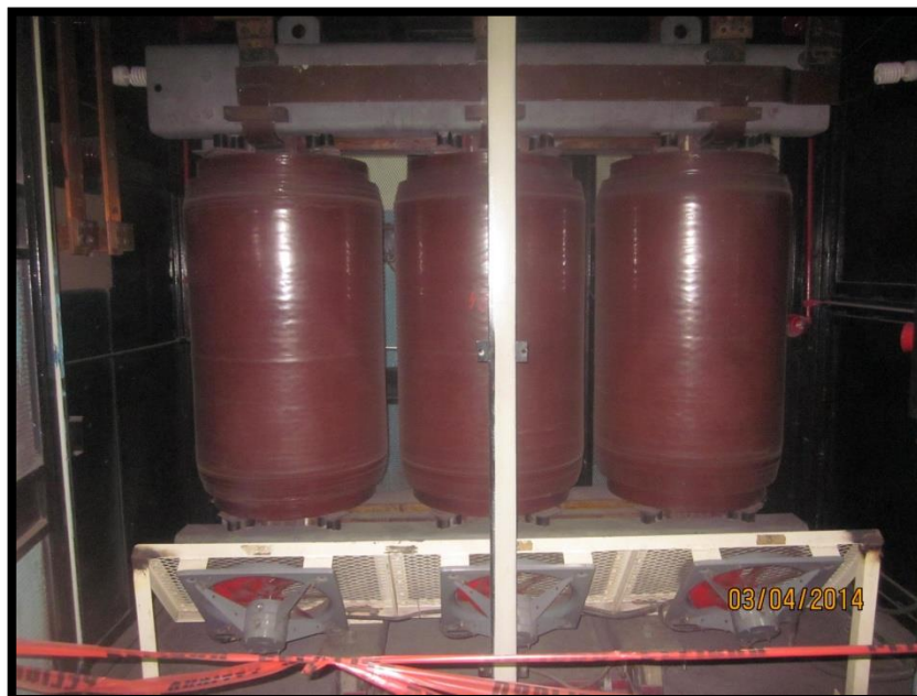
Fig. 3.17. Transformador de excitación 17 KV/1200 Vca; Fuente externa.
