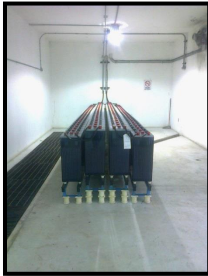
Fig. 3.9. Banco de baterías; 250 Vcd conexión en serie.
