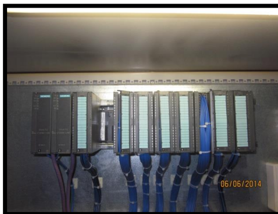
Fig. 3.36. Módulo de Adquisición Remota; Armado completo con tarjetas de entradas y salidas.
