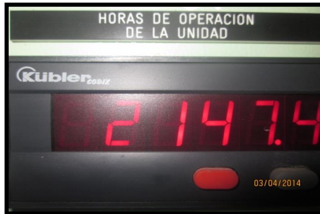
Fig.3.21. Reloj de registro digital; Horas de operación de una unidad generadora.
