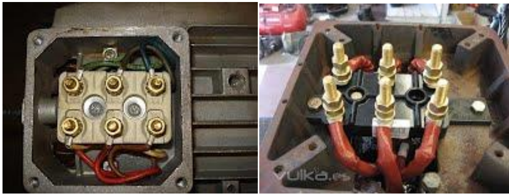
Caja de conexiones
