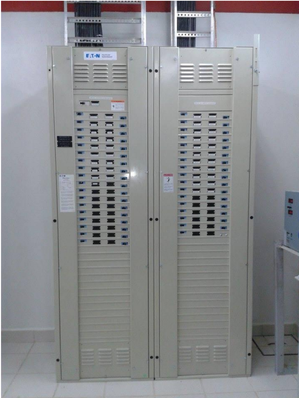
Fig. 3.5 tablero de circuitos de c.d.
