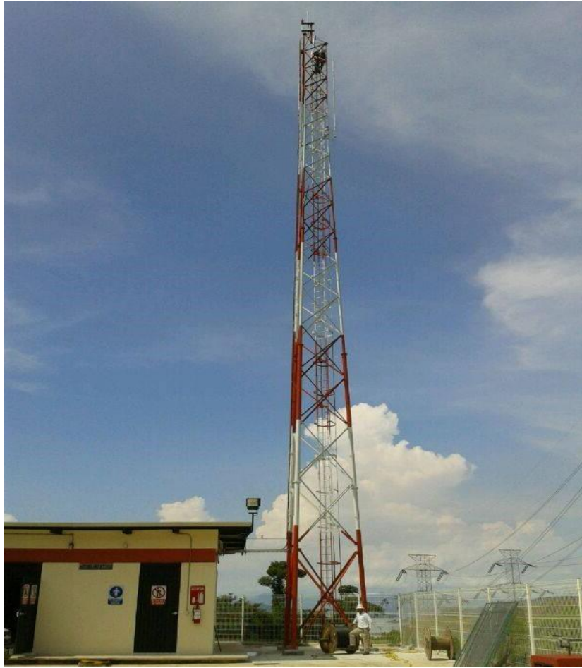
Fig. 3.3 modulo o caseta de protecciones y torre de comunicación.
