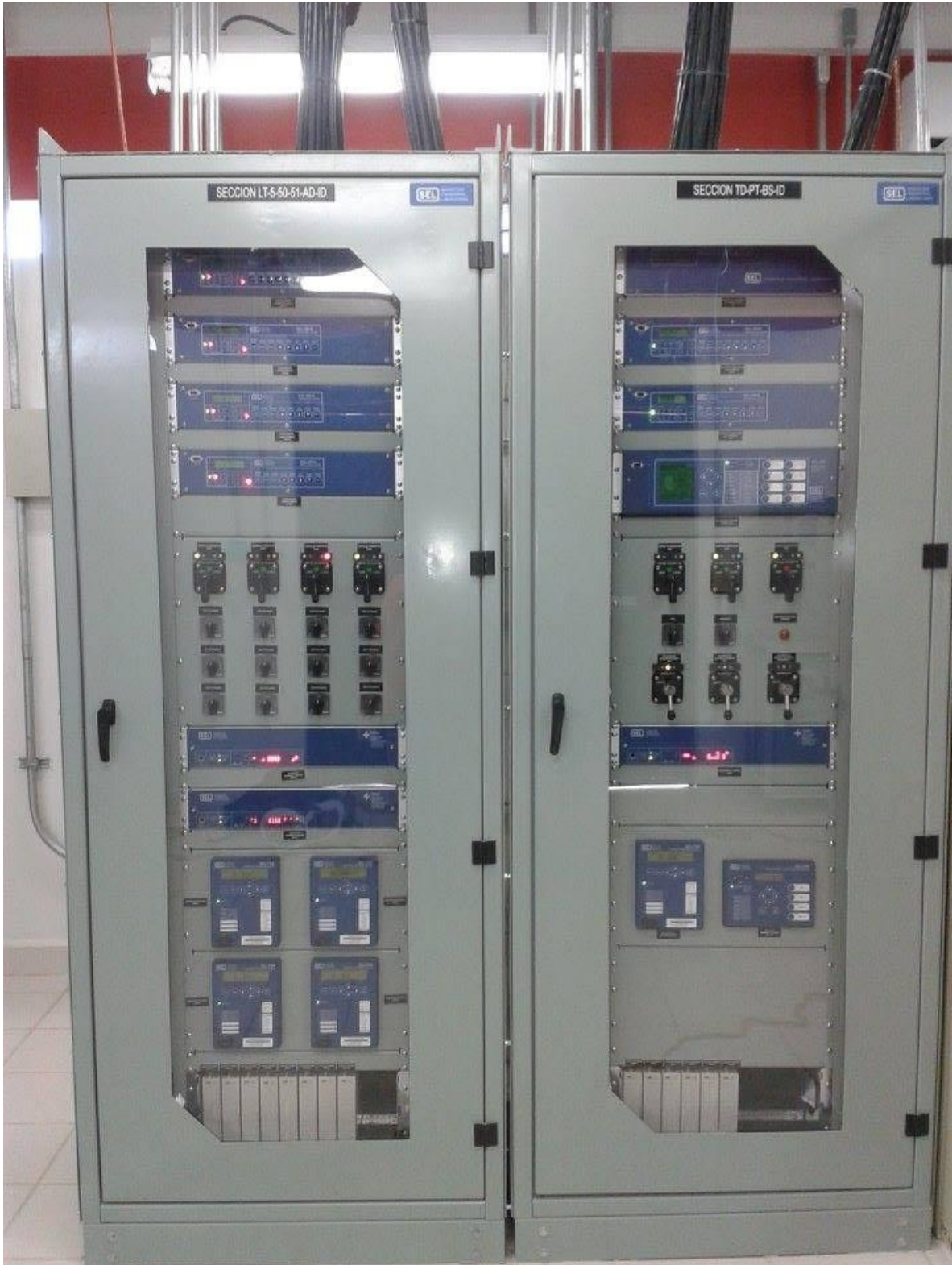
Fig. 3.8 tablero de protecciones.
