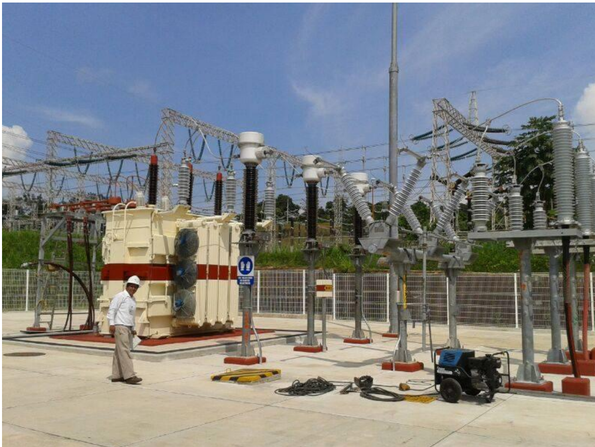
Fig. 3.1 Subestación malpaso III.
