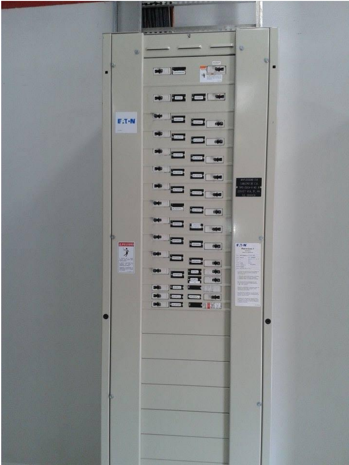
Fig. 3.6 tablero de circuitos de c.a.
