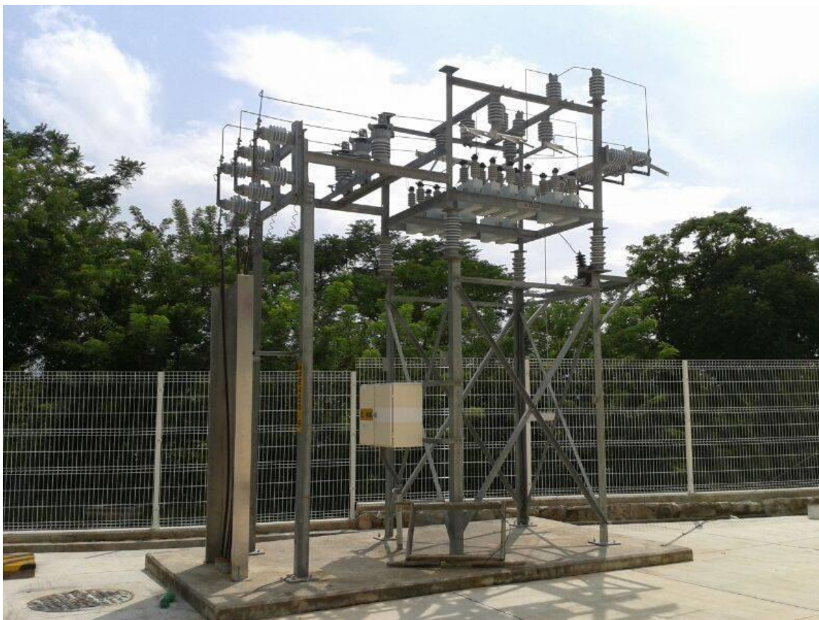
Fig. 3.2 banco de capacitores.
