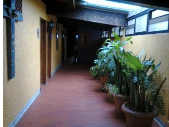
Fig. 3.18 Iluminación pasillo c)
