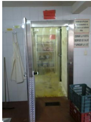
Fig. 3.11 Iluminación cocina fría
