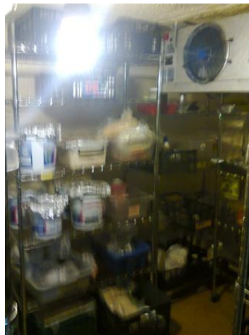
Fig.3.30 Iluminación cámara fría cocina de apoyo
