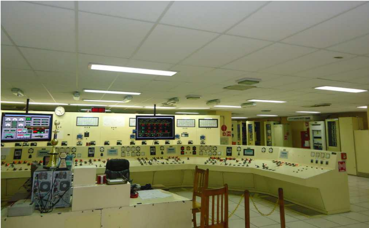
Fig.4.13 Aluminado actual sala de tableros C.H, peñitas.
