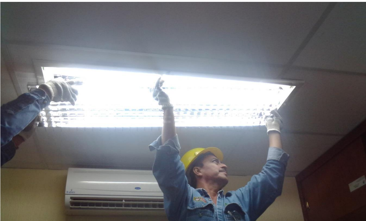
Fig.4.19 Informe Fotográfico de Cambios de luminarias.
