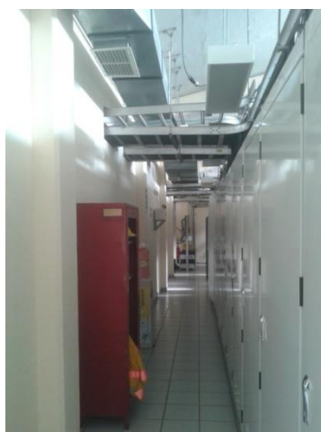
2.1.2 Parte trasera de los tableros
