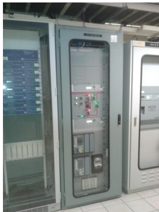
2.1.1 Tablero de protección 73990
