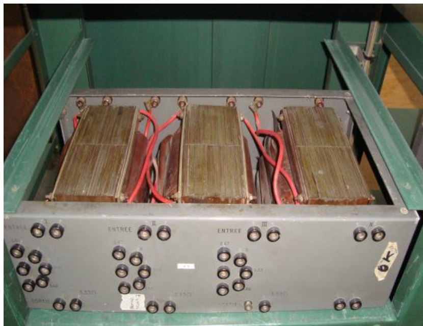
c) Reactor trifásico en conexión en Y
