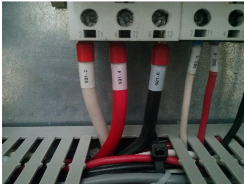
Fig.3.68.- Etiquetado de cables de potencia
