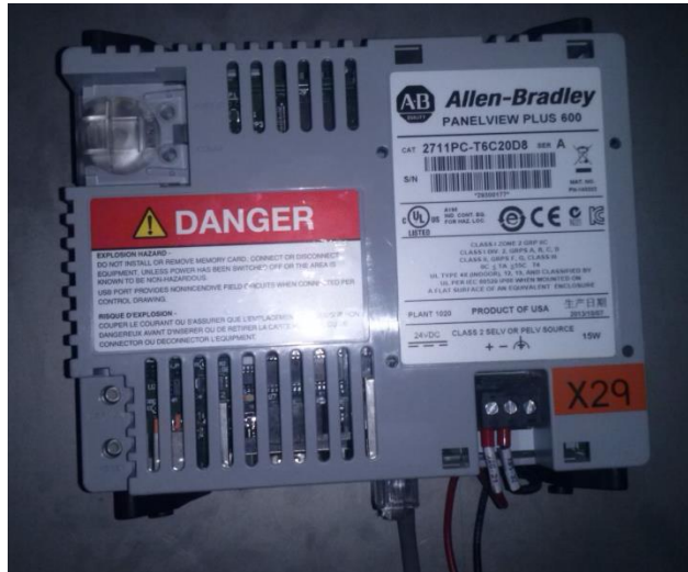
Fig.3.71.- Etiquetado de equipos
