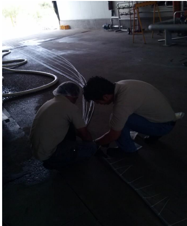
Fig.3.102.- Encinchado de cables de control
