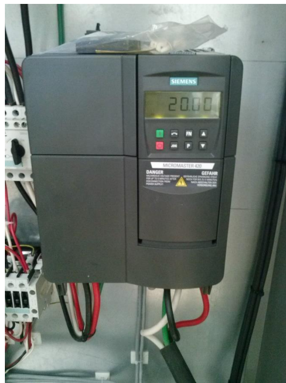
Fig.3.133.- Prueba de accionamiento variador de velocidad Micromaster 420
