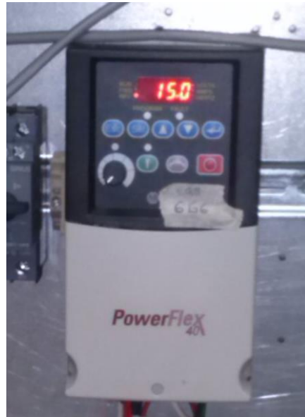
Fig.3.132.- Prueba de accionamiento variador de velocidad Power Flex 40
