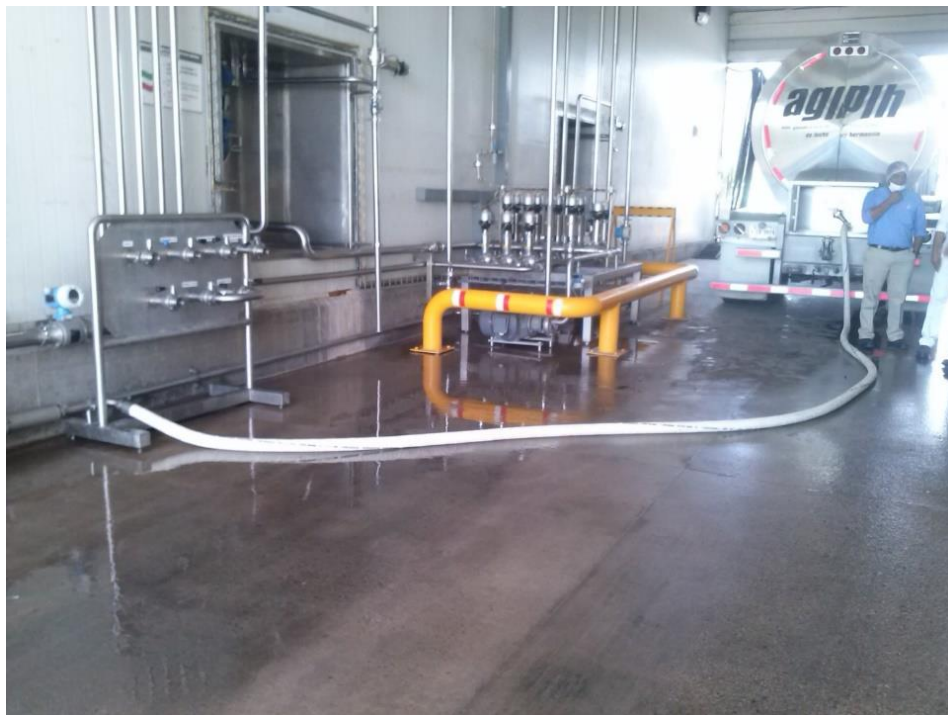
Fig.3.141.- Conexión de pipa para descarga a silo 6
