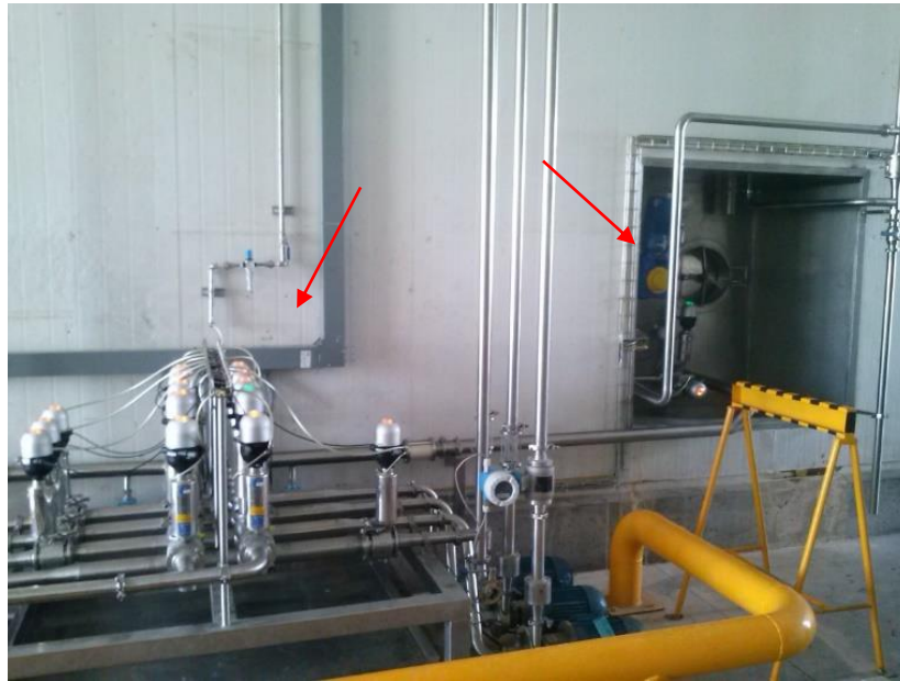
Fig.3.141.- Accionamiento de válvulas de descarga de pipas a silo 6
