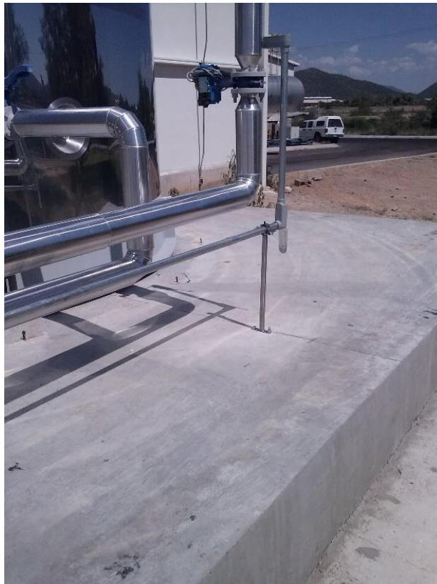
Fig.3.94.- Tubo conduit y soportería válvula de agua fría silo 5
