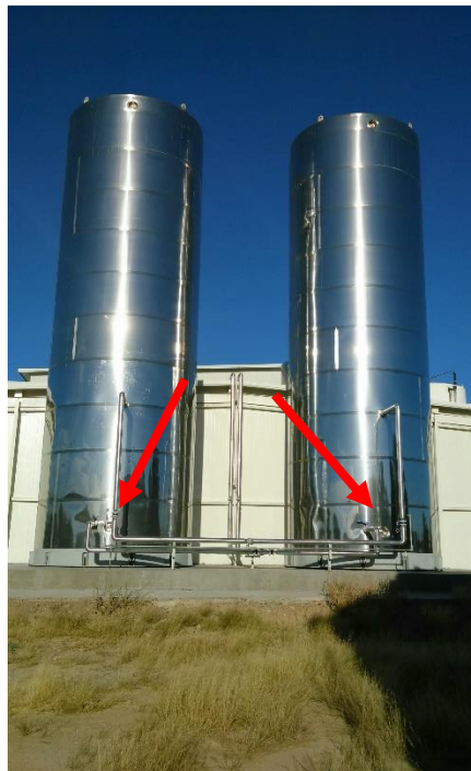
Fig.3.92.- Válvulas de agua fría
