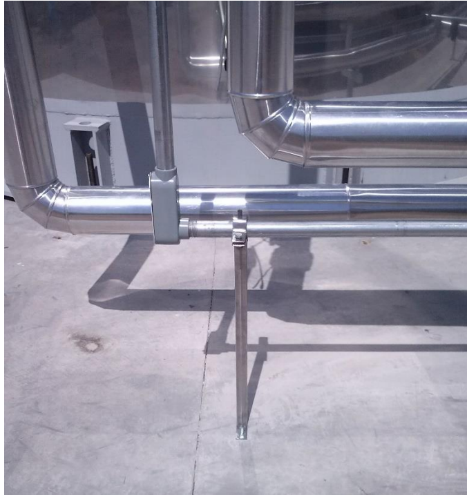
Fig.3.93.- Tubo conduit y soportería válvula de agua fría silo 6
