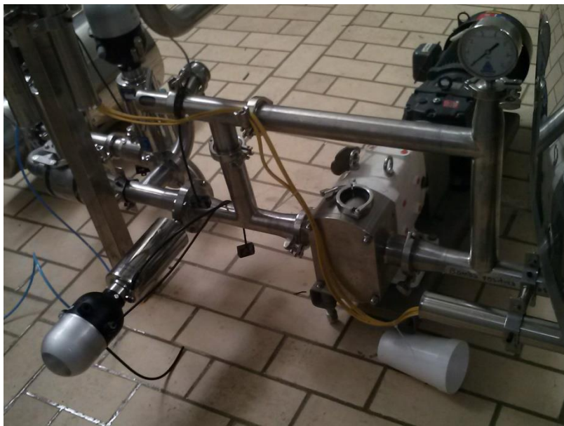
Fig.3.114.- Instalación cable ASI-bus área de descremadora
