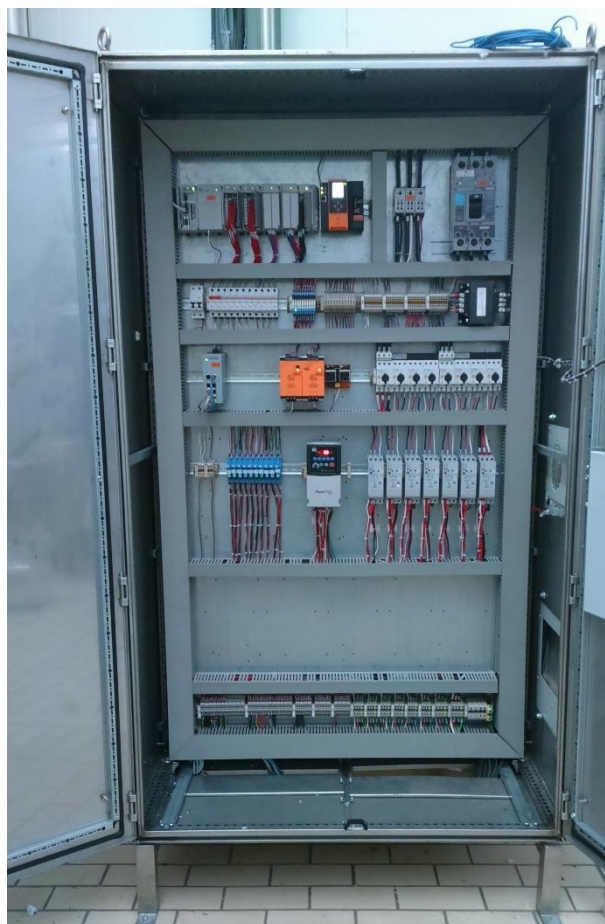
Fig.3.72.- Etiquetado de equipos
