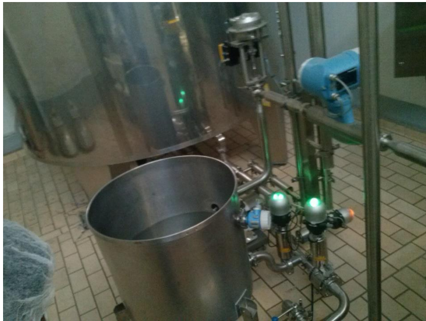
Fig.3.129.- Prueba de las válvulas del área de descremadora
