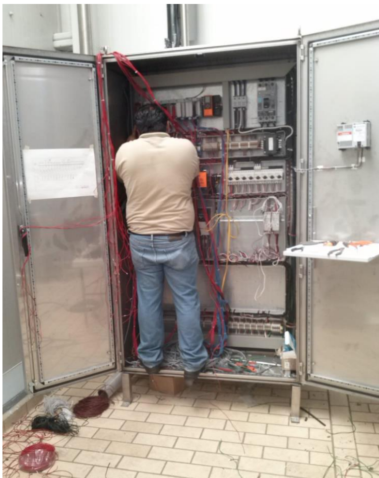
Fig.3.63.- Cableado del tablero
