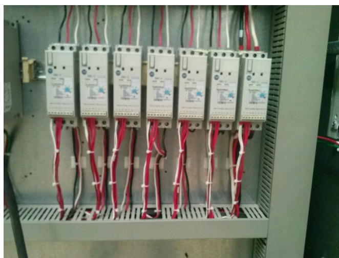
Fig.3.64.- Cableado del tablero
