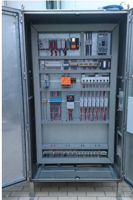
Fig.4.1.- Tablero eléctrico de control
