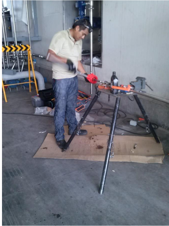
Fig.3.79.- Roscado de tubería de aire
