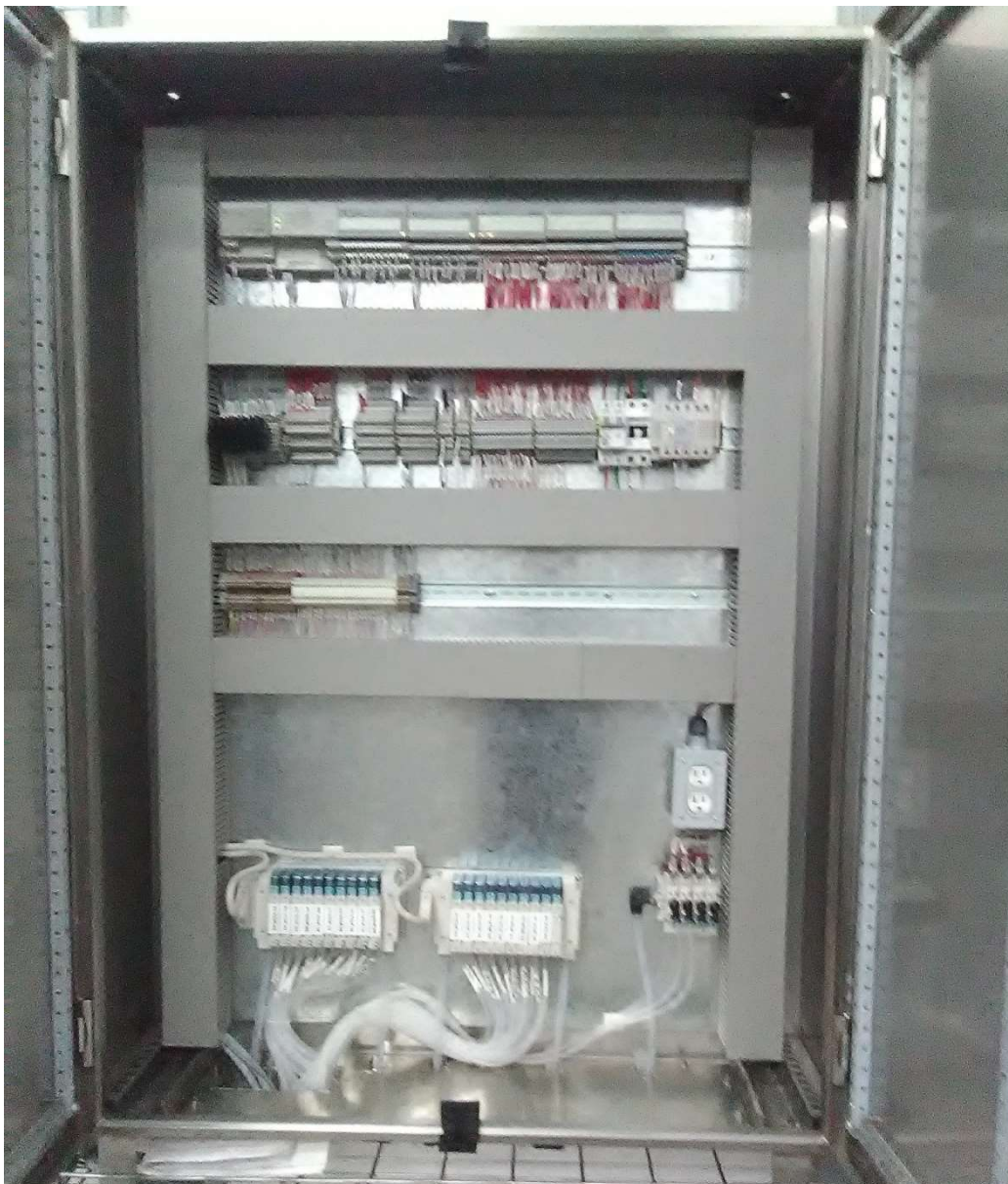
Fig.4.10.- Tablero de Control
