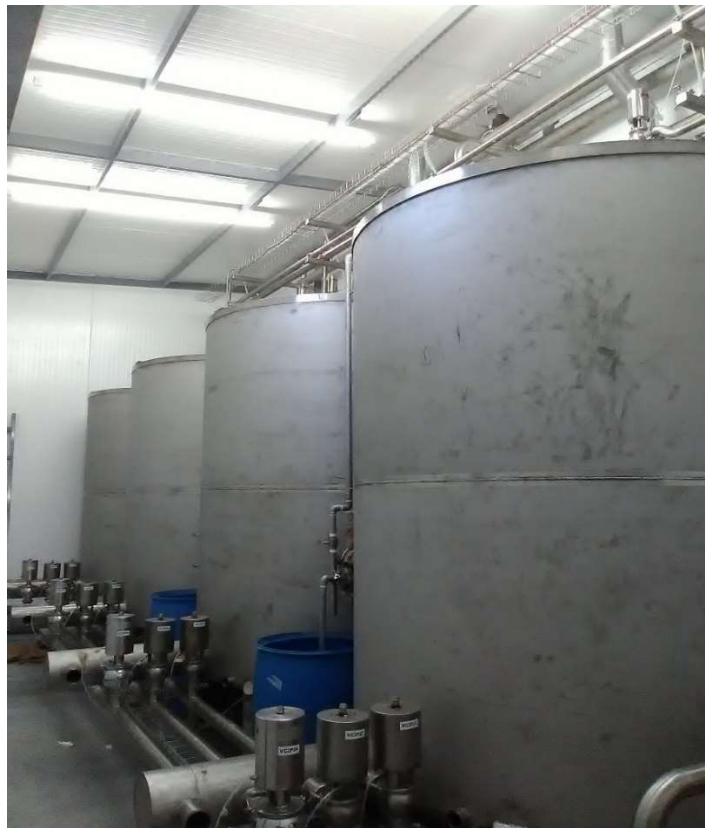
Fig.5.1. Cuarto de CIP
