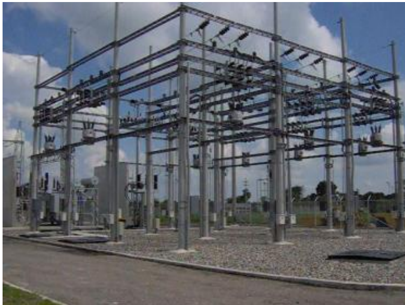
FIG. 8 SUBESTACION TIPO PATIO.
