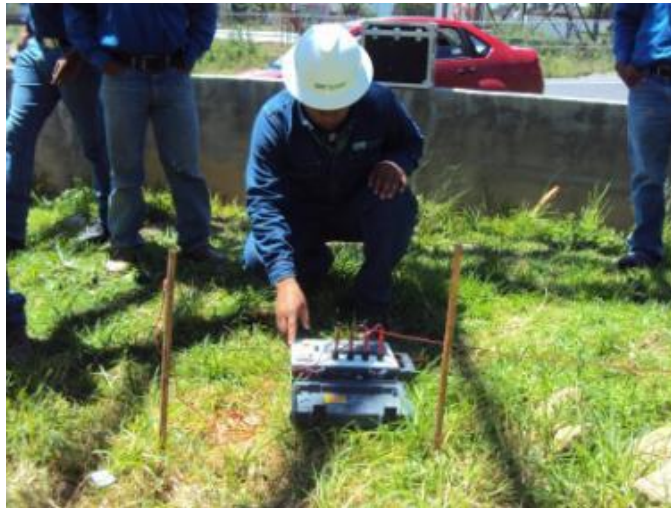
FIG. 38 MEDICION DE SISTEMA DE PUESTA A TIERRA ACOPLADO AI APARTARRAYO.
