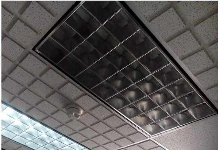
Fig.3.8 Lámpara fluorescente de 4 tubos de 32 watts.
