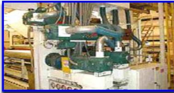
Fig. 3.11 Bomba de extracción de sólidos.
