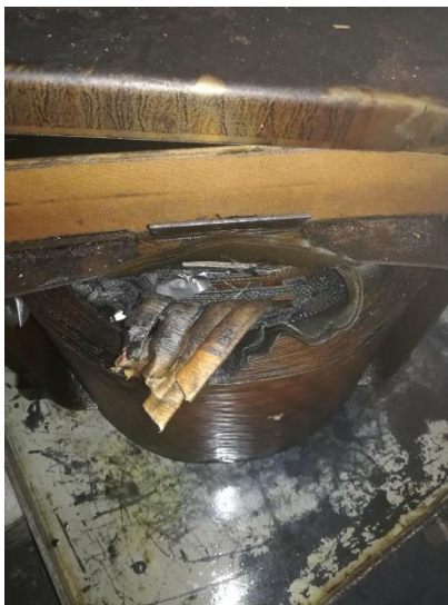
Fig. 2.15 Transformador fallado por sobrecarga.
