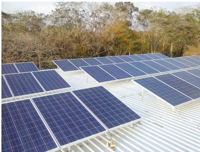
Figura 4.9 Vista frontal de los paneles instalados en la empresa ABIOSA
