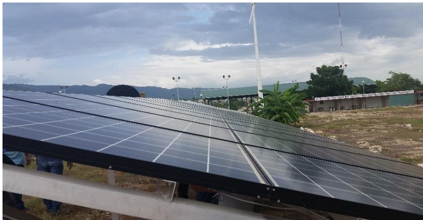
Figura 4.3. Central Fotovoltaico de 5.5 kW
