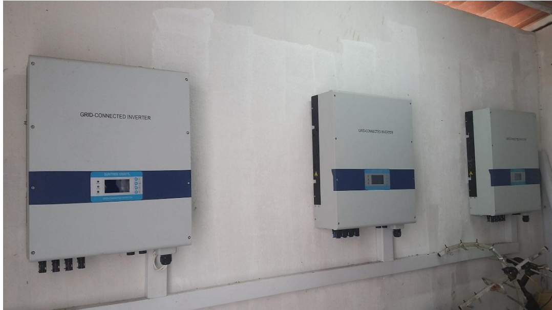
Figura 4.10 Inversores SUNTREE conectados en la central de ABIOSA
