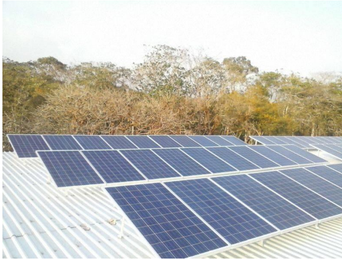
Figura 4.8 Primer subcampo de paneles conectados
