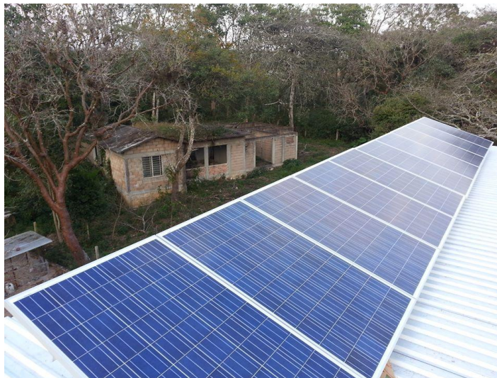
Figura 4.7 Paneles instalados en la empresa ABIOSA
