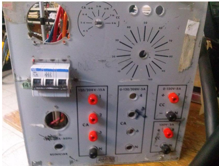
Figura 17. Fuente trifásica del laboratorio de ingeniería eléctrica.
