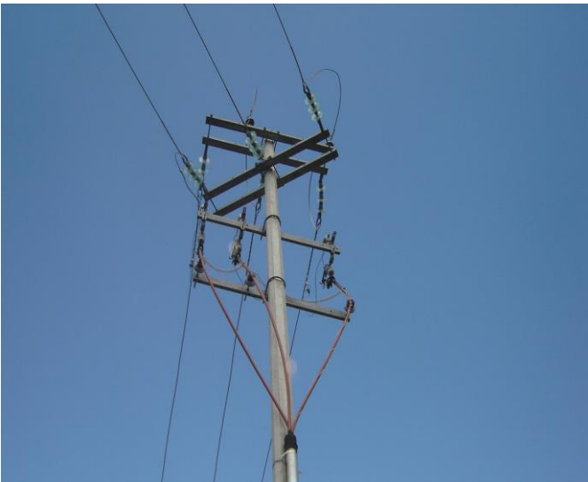
Transición aéreo - subterránea de C.F.E a ITTG.
