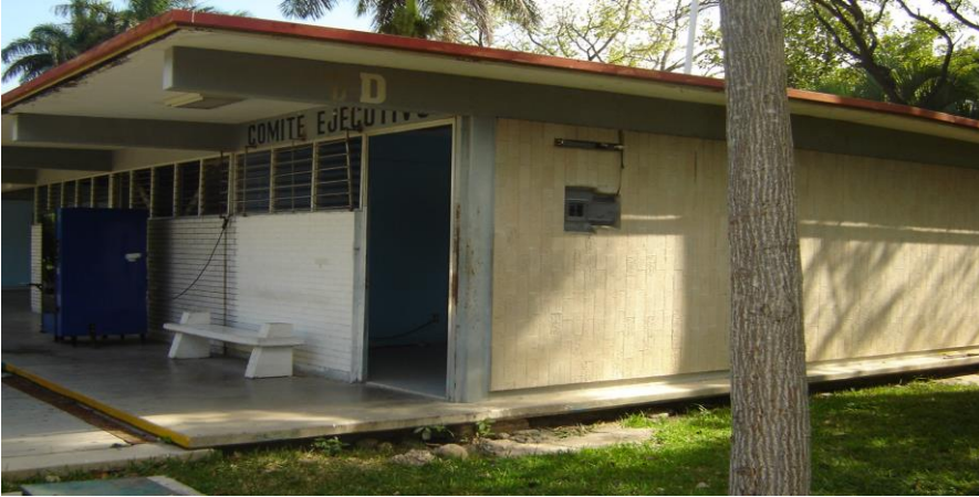
Ubicación de tablero de control de luminarias.
