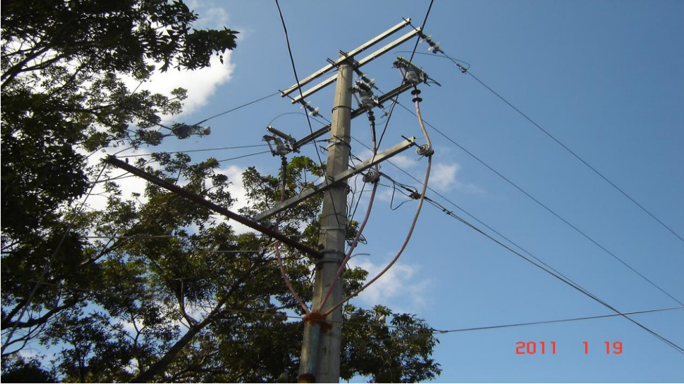
Transición aéreo- subterránea de CFE a ITTG.
