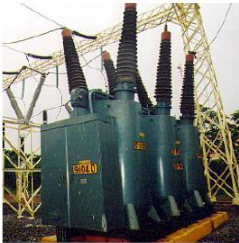
Interruptor trifásico en gran volumen de aceite con un tanque por polo. Marca Westinghouse, tipo 242GW40, clase 242 kV, 1600 A y 40 kA de capacidad interruptiva y mecanismo neumático.
