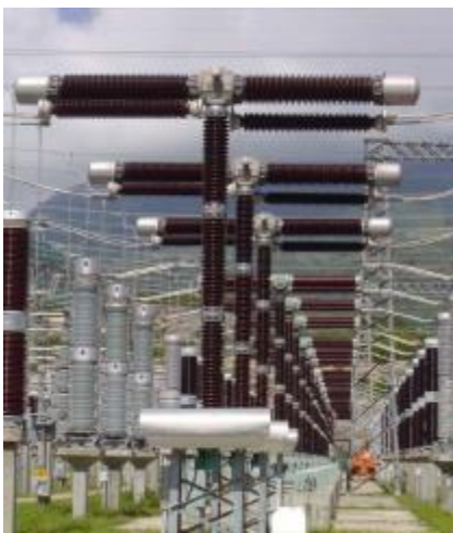
INTERRUPTOR DE POTENCIA PARA 400 KV MARCA: SIEMENS MODELO: 3AP2
