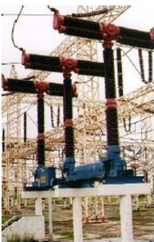
Interruptor tipo soplo en SF 6 , tanque vivo, marca IMEX, tipo 3AS2, 245 kV, 2000 A y 40 kA de capacidad interruptiva con mecanismo hidráulico.
