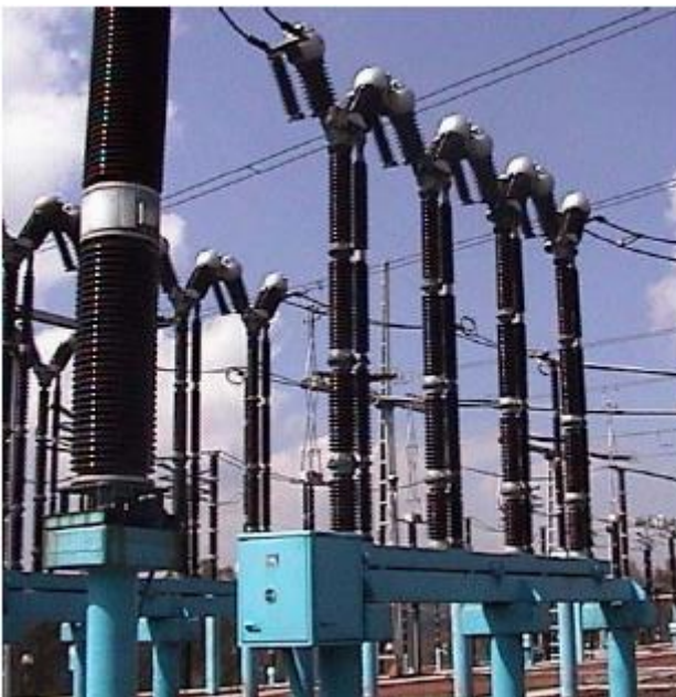
Interruptor en pequeño volumen de aceite marca Sprecher & Schuh de 115 kV con mecanismo de resorte.
