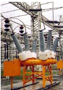
Interruptor tipo soplo en SF 6 , tanque muerto, marca Alstom, tipo DT1-145F1 de 145 kV, 2000 A, 40 kA de capacidad interruptiva con mecanismo de resorte.
