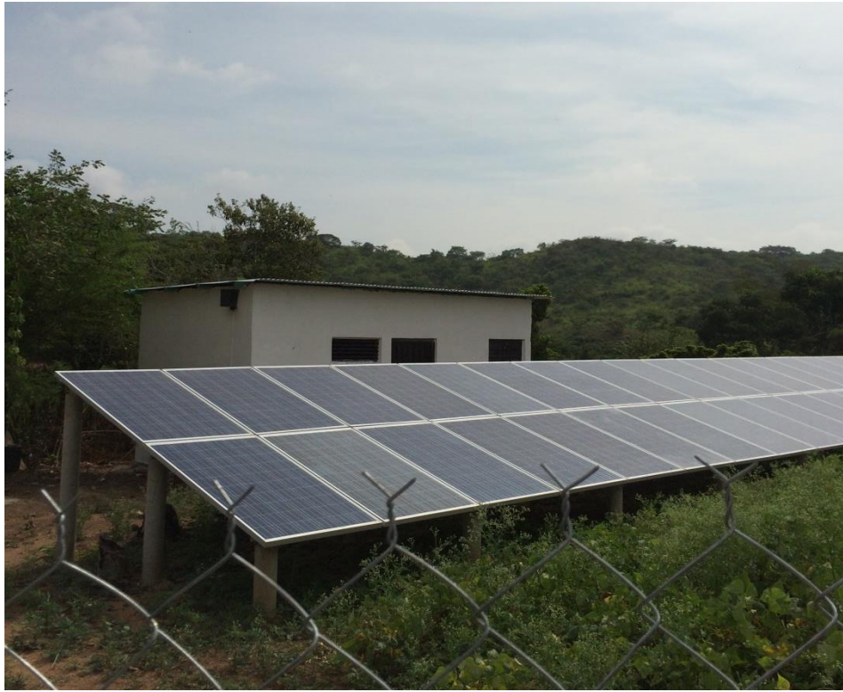
Fig. Anexo. B3 Central Fotovoltaica de 5.5 KWh.
