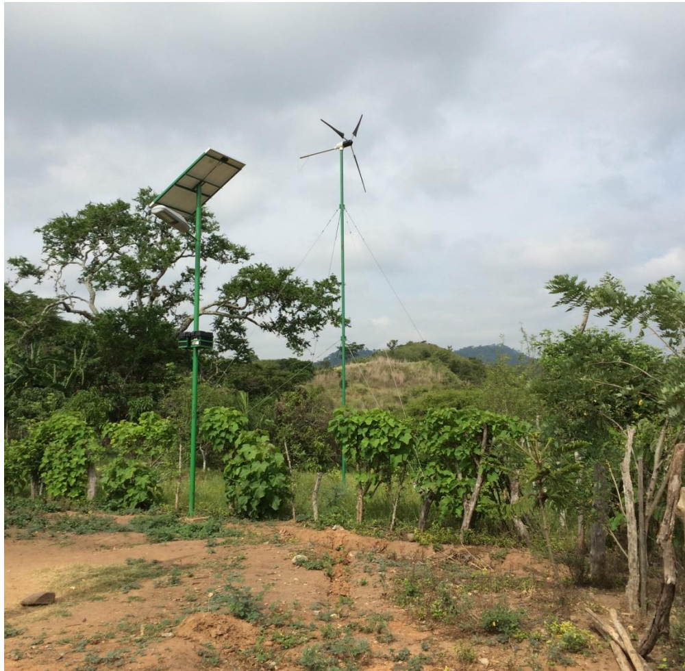
Fig. Anexo.B9 Sistema Híbrido de Generación Eléctrica.
