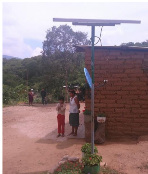
Fig. Anexo.B6 Sistema de iluminación individual para viviendas.
