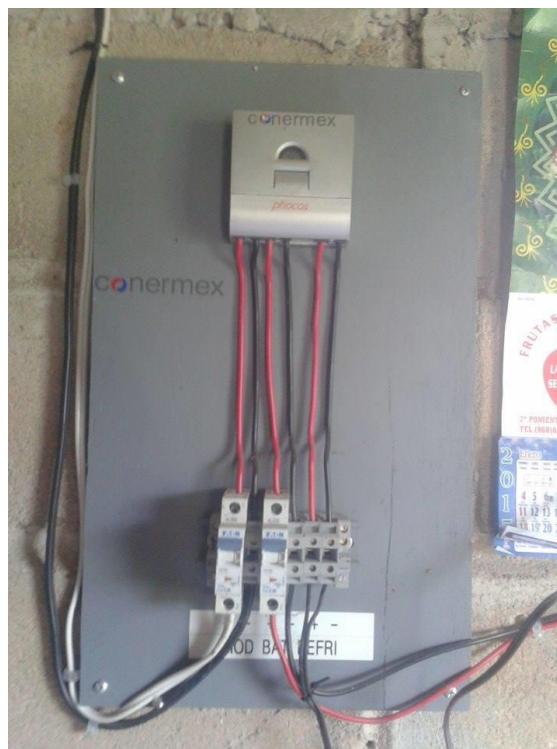
Fig. 4.13 Sistema de Protecciones del Refrigerador Comunitario.
