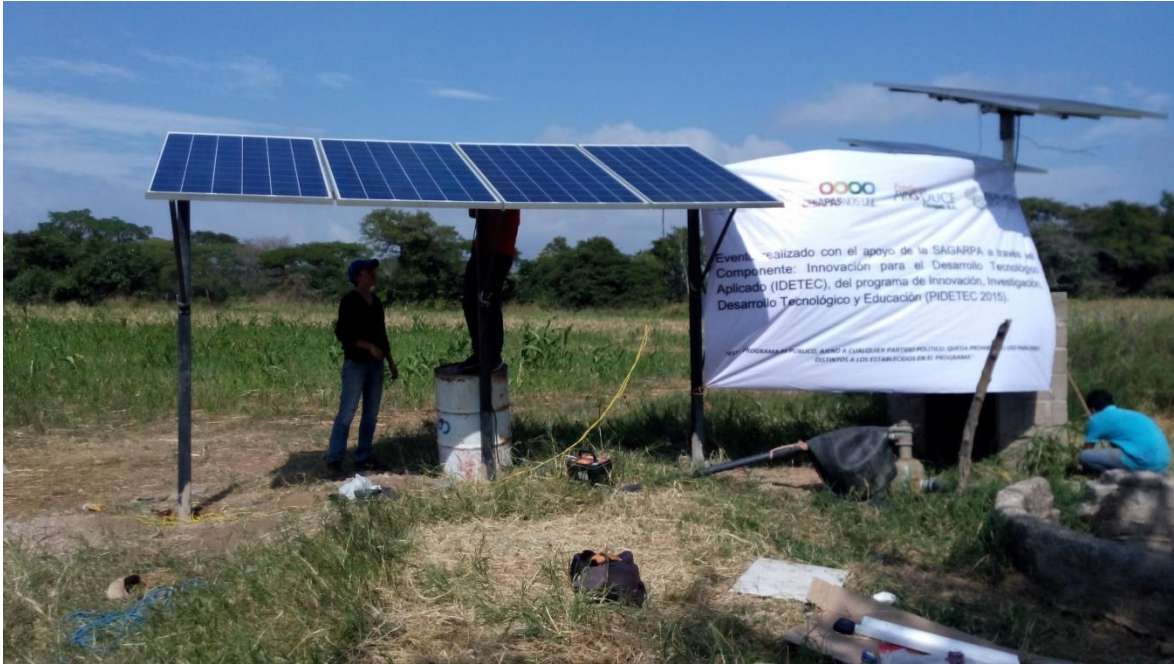
Fig. 4.13 Sistema de Bombeo Solar Fotovoltaico.
