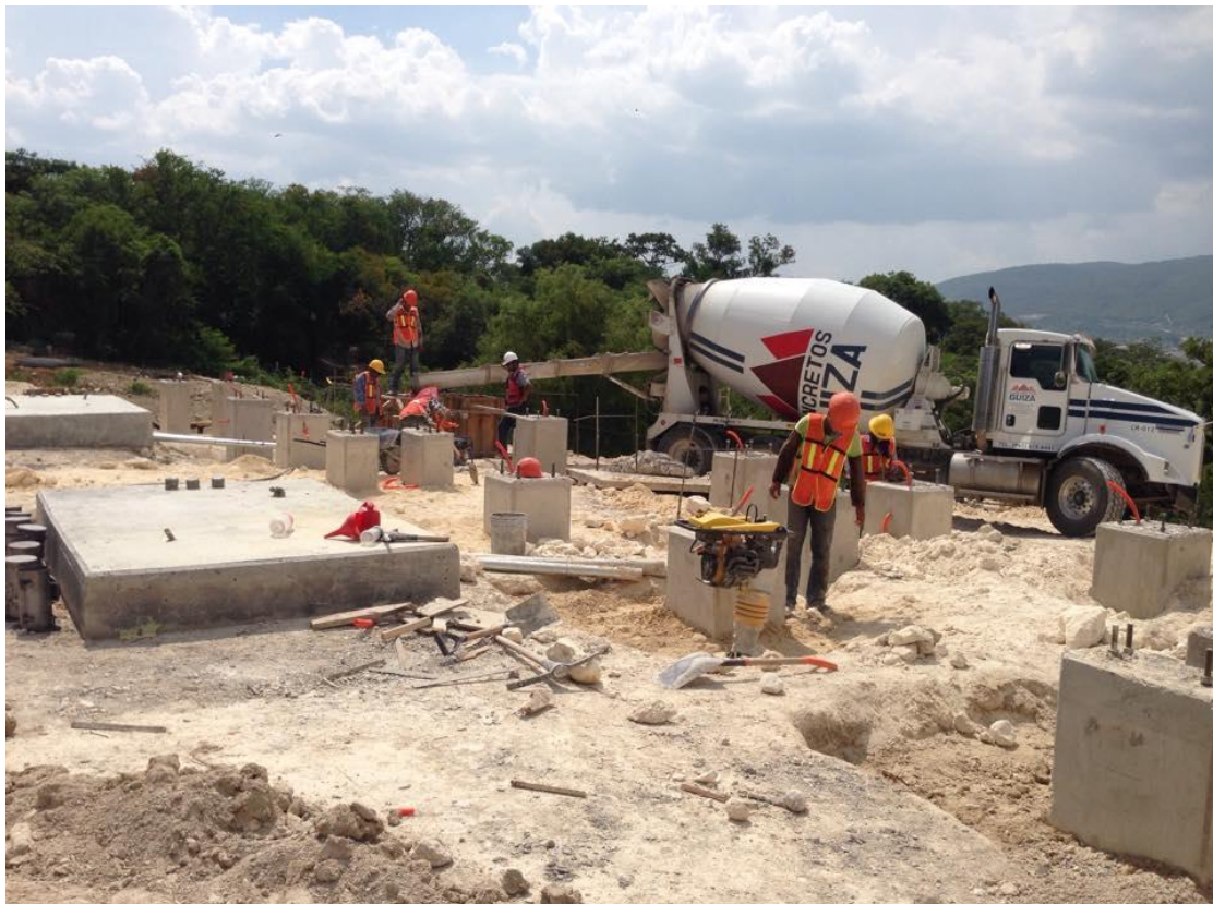
Fig. 7.8 Compactación del área perimetral de los soportes tubulares y bases de los interruptores de potencia.
