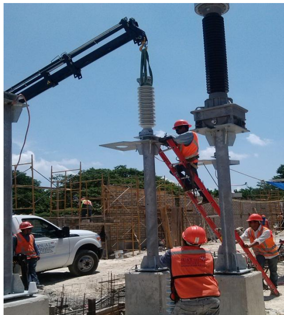
Fig. 4.10 Montaje de apartarrayos
