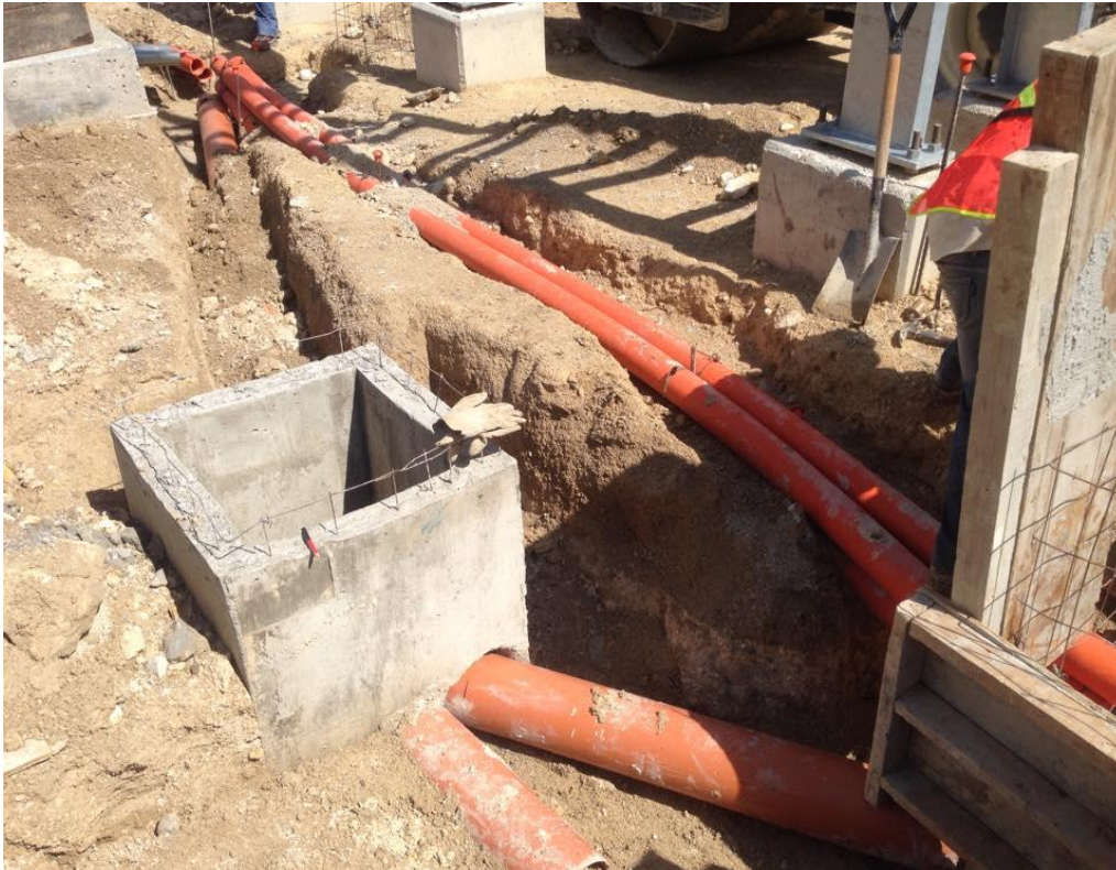
Fig. 7.13 Tubería conectada de los registros eléctricos del patio con la trinchera de la caseta de control.
