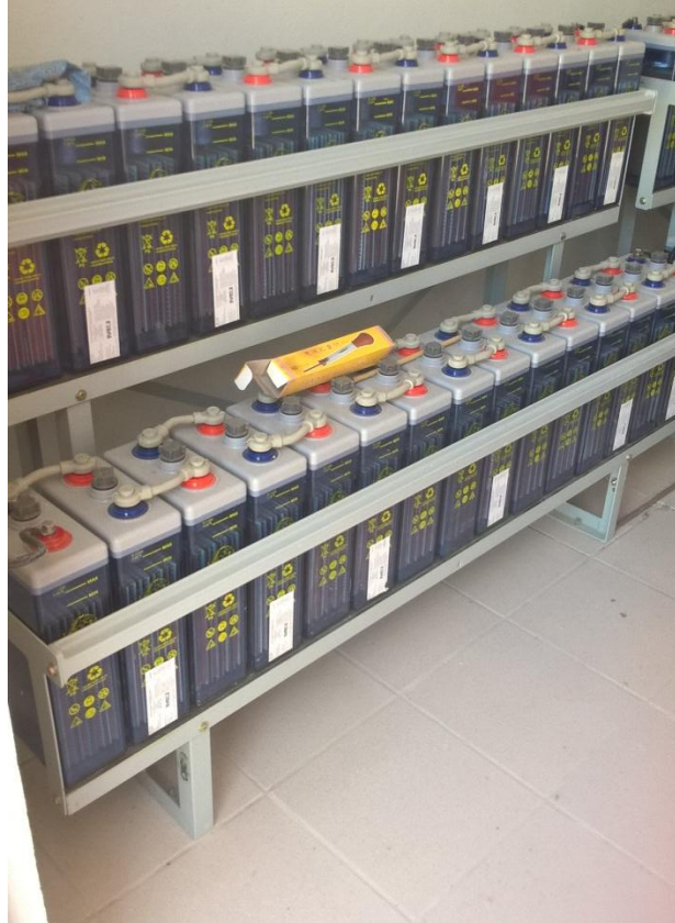
Fig. 7.24 Banco de baterías de la subestación.
