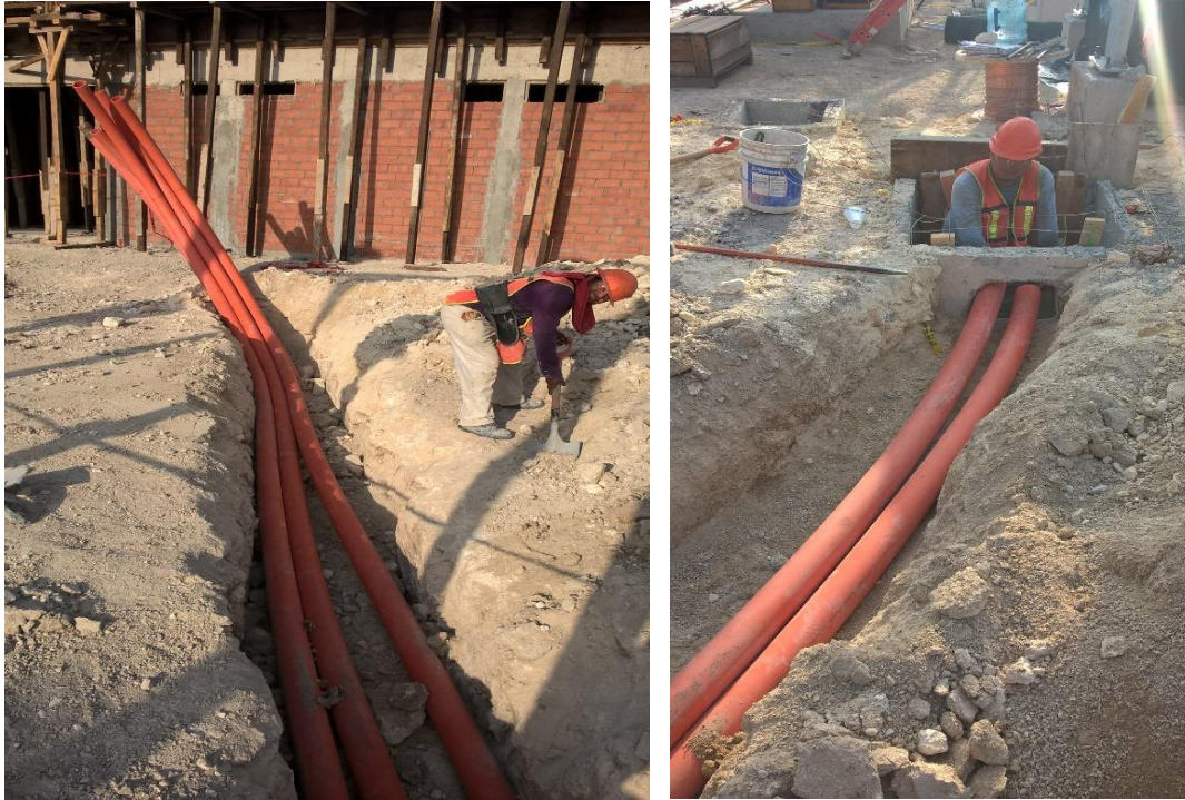
Fig. 7.20 Ductos y tuberías para los cables de potencia.
