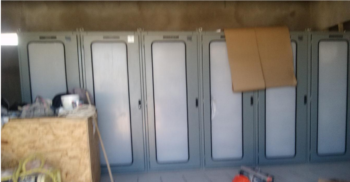
Fig. 4.11 Tableros de Protección, Control, y Medición
