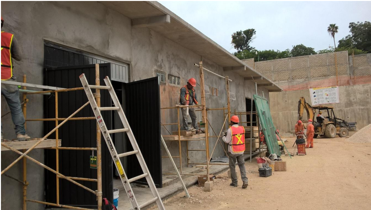
Fig. 7.22 Repello exterior e interior de la pared de la caseta de control.
