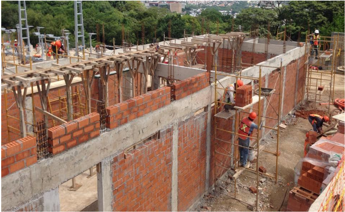
Fig. 7.15 Armado de Cadenas y traves para la loza de la caseta de control.
