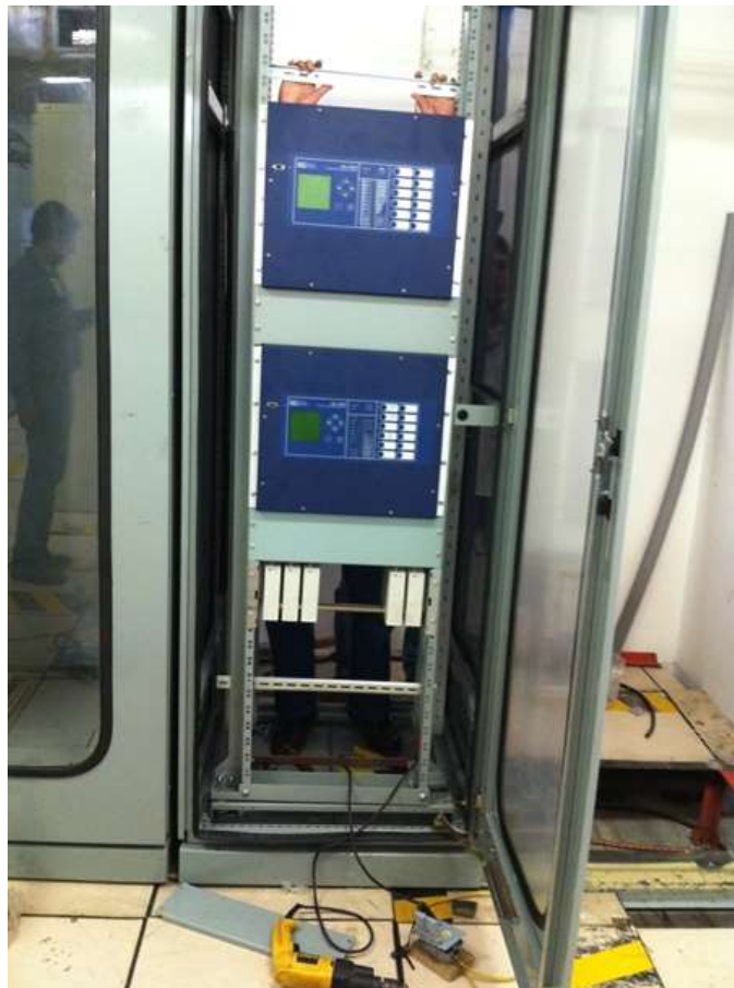
Figura 44. Protección diferencial digital de bus marca SEL 487B.
