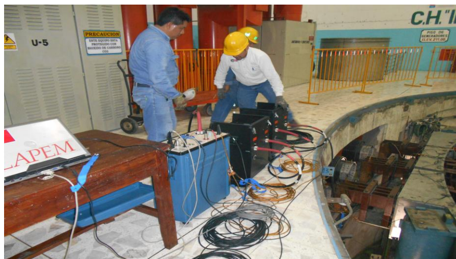
Fig.3.39 Prueba de resistencia de aislamiento LAPEM
