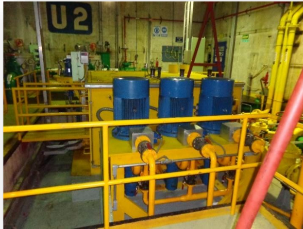
Figura 3.20 bombas de regulación (M-311, M-312 y M-313).
