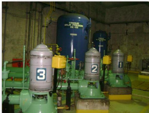
Fig. 3.23 bombas de achique de agua de 50 hp.
