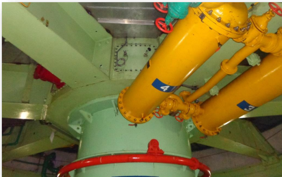
Fig. 3.15 Chumacera combinada de la turbina.
