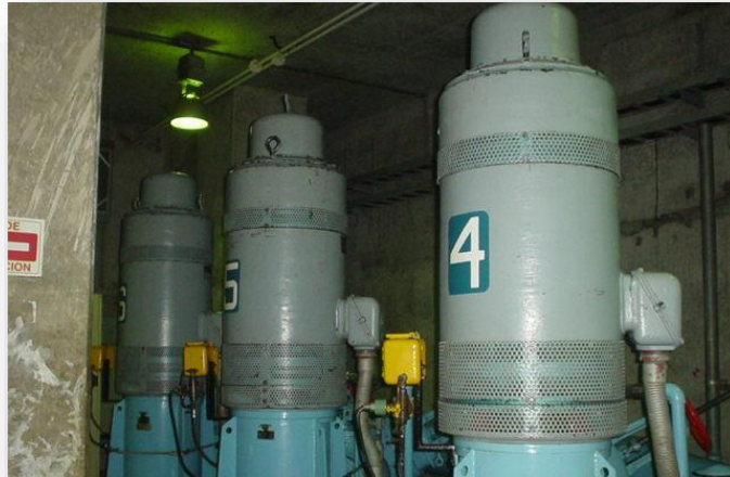
Fig. 3.24 bombas de achique de 300 hp.
