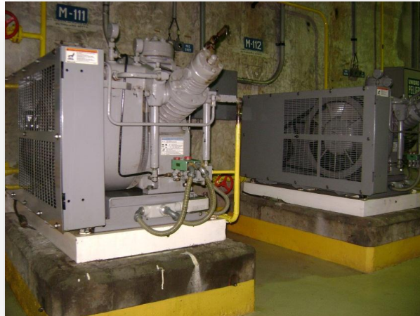
Figura 3.21 compresores reciprocantes M-111 y M.112.
