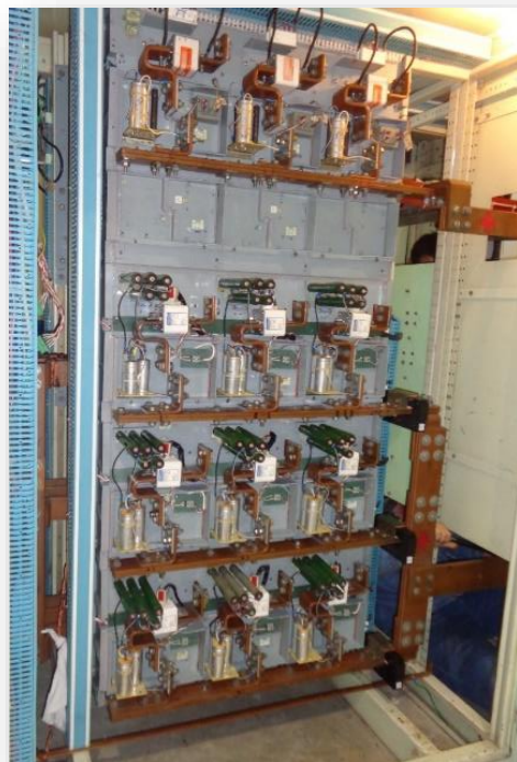
Fig. 3.17 Banco de Tiristores.
