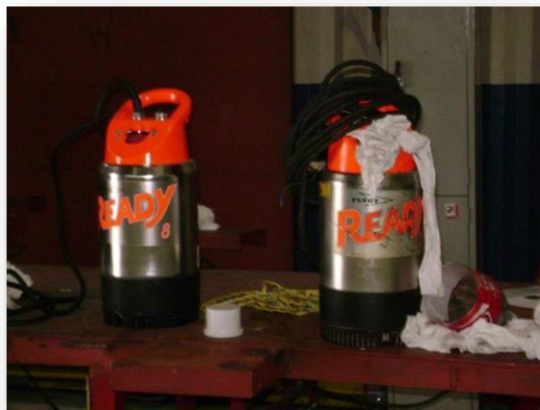
Fig. 3.25 Bombas de achique de agua infiltrada M-361 y M-362.
