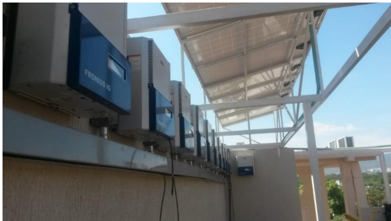
Inversores para interconexión con CFE de Condominios Santa Alicia
