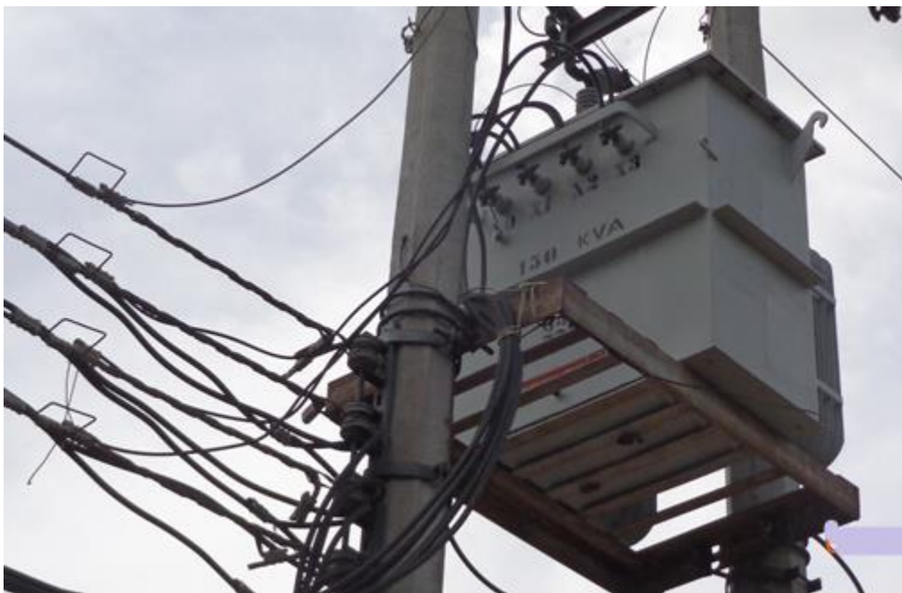
Figura A8. Transformador de 150 KVA – Sección 2
