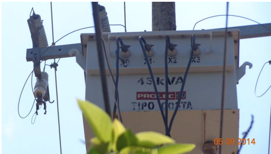
Figura A6. Transformador de 45 KVA – área de servicios.
