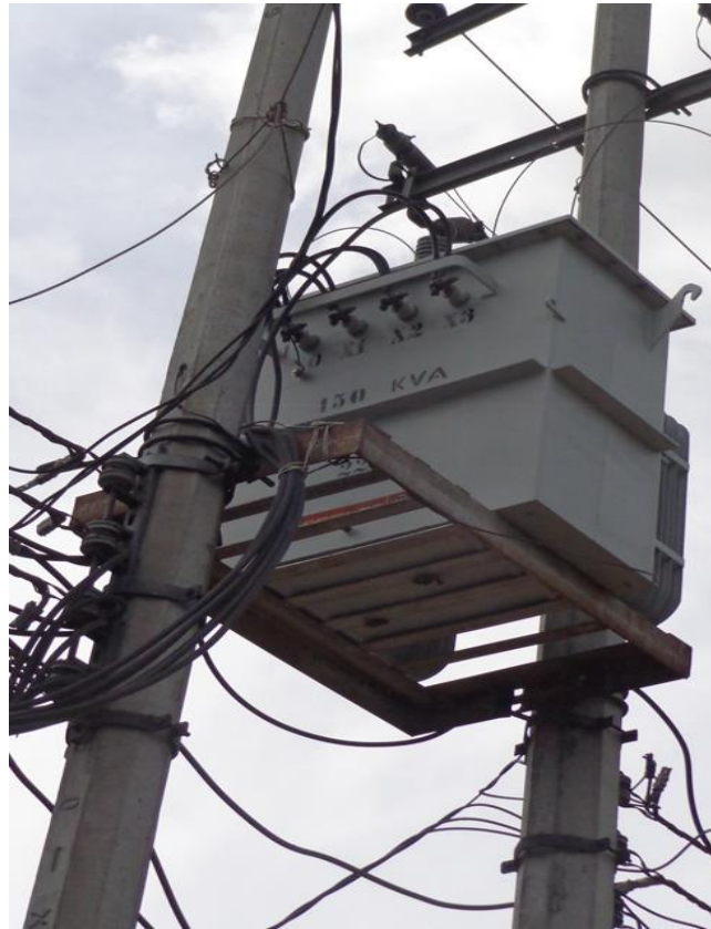
Figura A7. Transformador de 150 KVA – Sección 1
