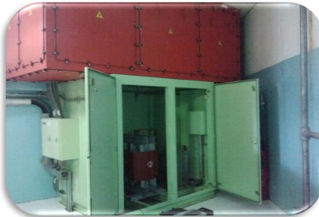
Figura 3.3 transformador neutro de generador
