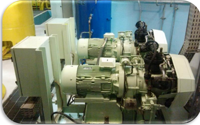
Fig.4.6 compresores de aire
