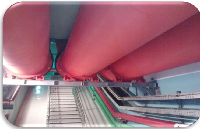
Fig.4.5 Bus de fase aislada en su trayectoria a galería de transformadores
