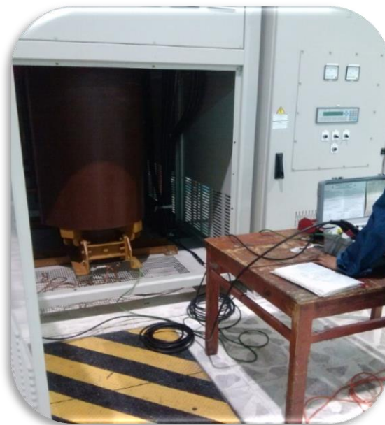
Fig.4.1 transformador de excitación
