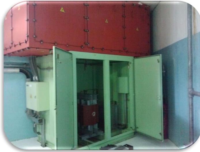
Fig.4.3 Transformador neutro del generador
