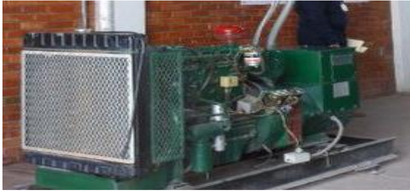
Foto.5 La planta de emergencia anterior
