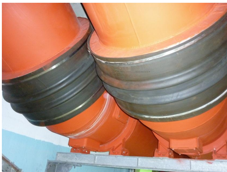
Bus de fase aislada en su trayectoria a galería de transformadores
