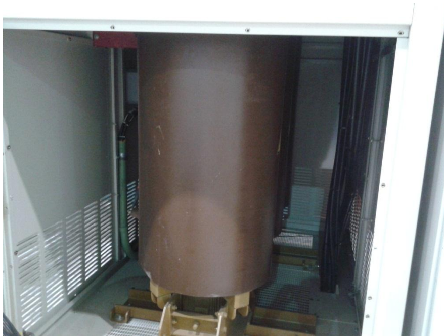
Transformador de excitación
