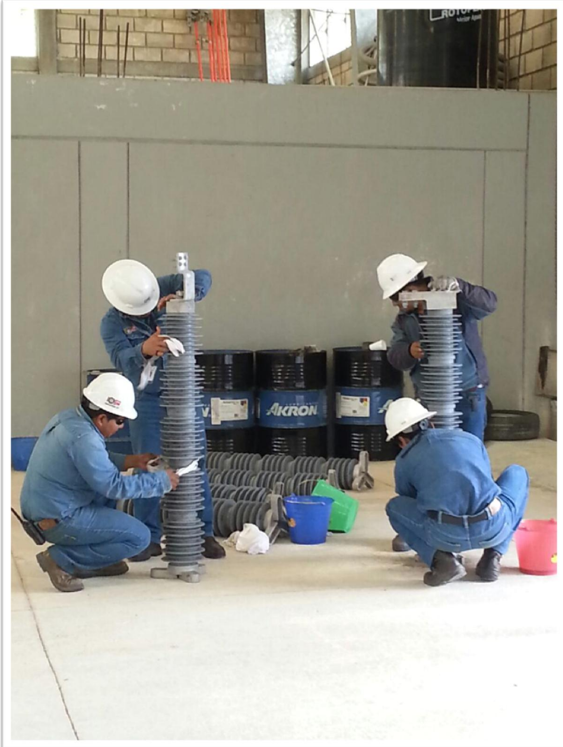
Fig. A5 LIMPIEZA DE APARTARRAYOS.
