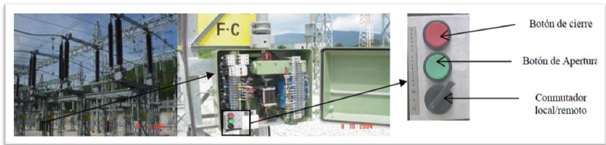
Fig. 1.14 CUCHILLA DESCONECTADORA DE APERTURA VERTICAL.
