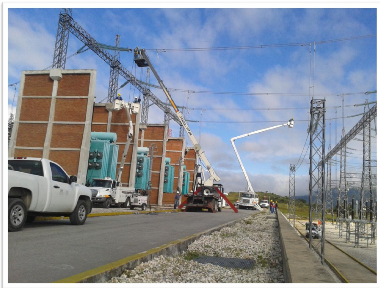
Fig. A4 MANIOBRAS PARA EL RESTABLECIMIENTO DE ENERGÍA ELÉCTRICA A CAUSA DE UN FALLO SEVERO.
