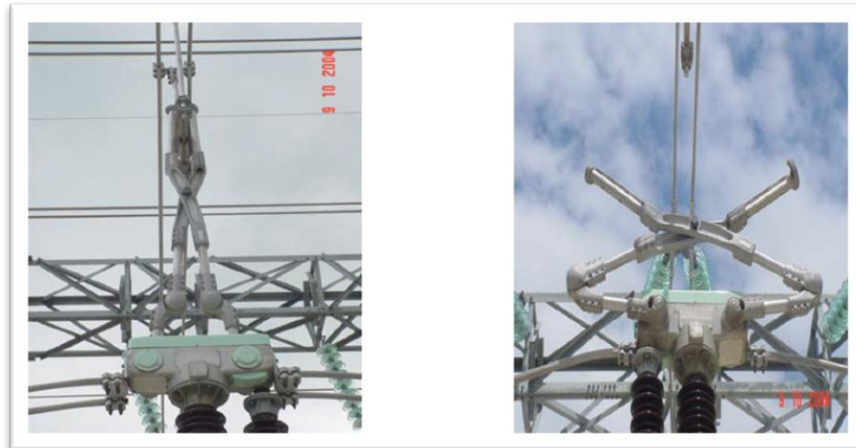
Fig. 1.17 CUCHILLAS PANTÓGRAFO DE 115 KV.
