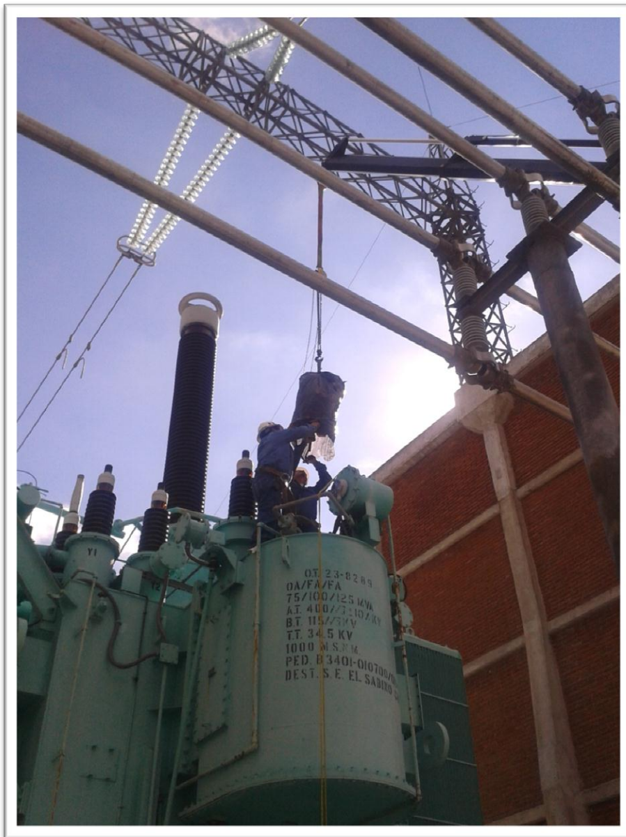
Fig. A2 MATENIMIENTO AL CAMBIADOR DE DERIVACIONES DEL TRANSFORMADOR MONOFASICO FASE "A" DE LA SUBESTACIÓN EL SABINO.
