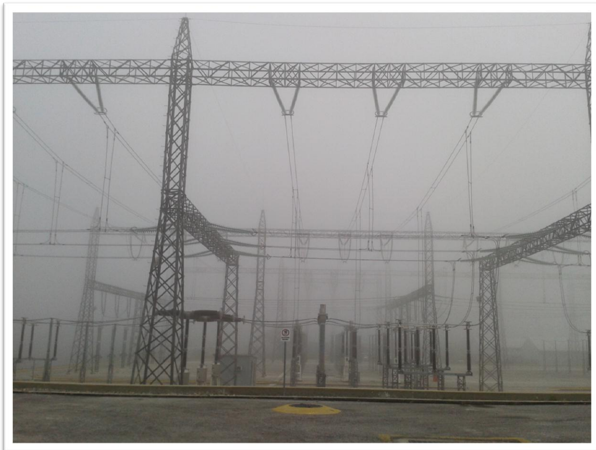
Fig. A1 SUBESTACIÓN “EL SABINO” DONDE SE DEMUESTRA QUE ES TIPO INTEMPERIE Y A QUE CONTAMINACIÓN AMBIENTAL ESTA EXPUESTA.
