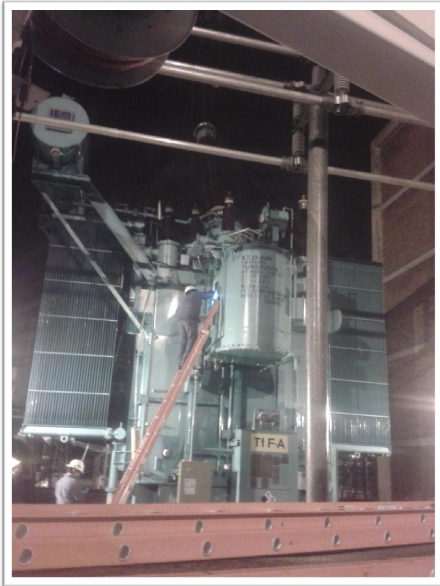
Fig. A3 CONSECUENCIA POR DEFECTO DE FABRICACION DE UN TRANSFORMADOR.
