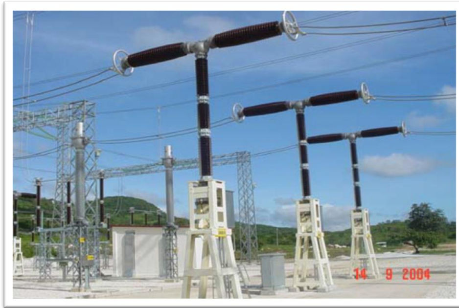
Fig. 1.10 INTERRUPTOR DE POTENCIA DE LA SUBESTACION “EL SABINO”.
