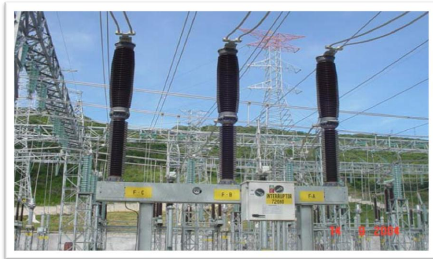
Fig. 1.11 INTERRUPTOR DE POTENCIA DE 115 KV.
