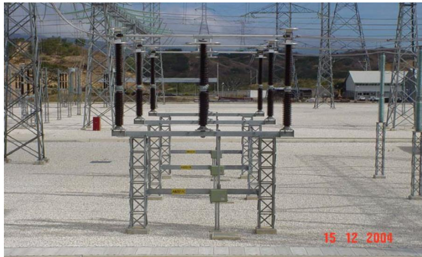
Fig. 1.13 CUCHILLAS DESCONECTADORAS DE 400 KV.
