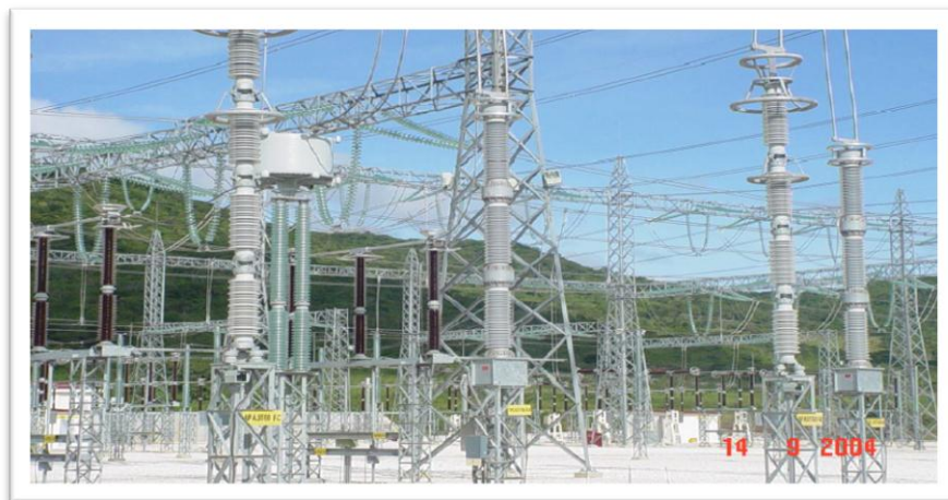
Fig. 1.20 APARTARRAYOS DE 400 KV DE LA SUBESTACIÓN “EL SABINO”.
