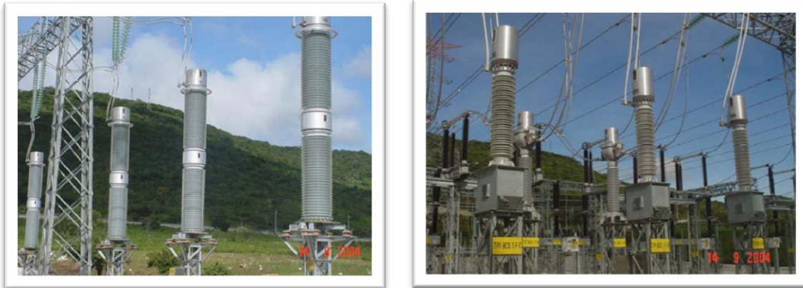
Fig. 1.19 TRANSFORMADORES DE CORRIENTE 400 Y 115 KV.
