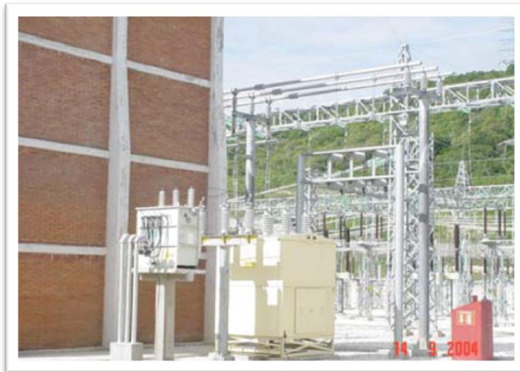
Fig. 1.21 INTERRUPTOR DEL TERCIARIO DE 34.5 KV.
