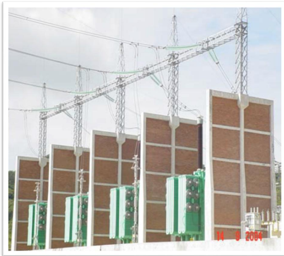
Fig. 1.2 BANCO DE TRANSFORMADORES.
