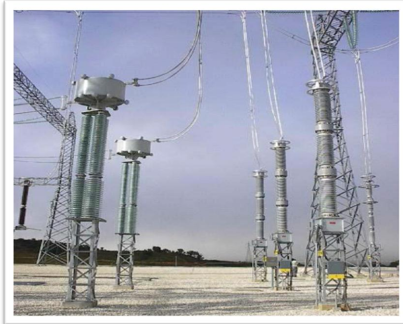
Fig. 1.18 TRANSFORMADORES DE POTENCIAL CAPACITIVOS DE 400 KV.
