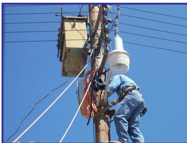
Fig. 21 Instalación del equipo de medición
