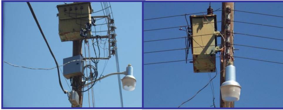
Fig. 25 Equipo de medición instalado en la red de CFE.
