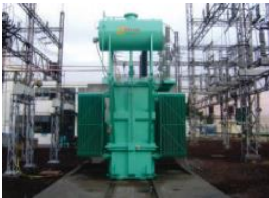
Fig.2.2 transformador de 18/24 MVA, 115/13.2 KV.
