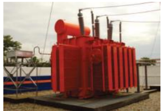
Fig.2.5 transformador de 12/14/16 MVA, 115/13.2 KV.
