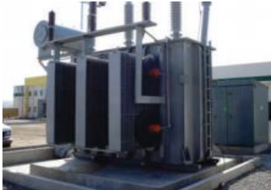
Fig.2.4 transformador de 6/7.5 MVA, 115/13.2 KV.
