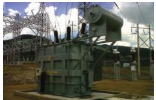
Fig.2.3 transformador de 10/12.5/15 MVA, 115/13.2 KV.
