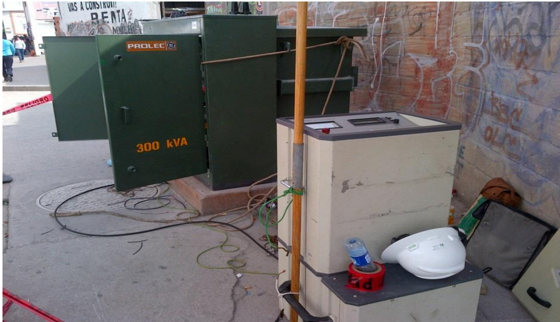
Foto 3.- Transformador de 300 KVA realizando la prueba de Resistencia de Aislamiento.
