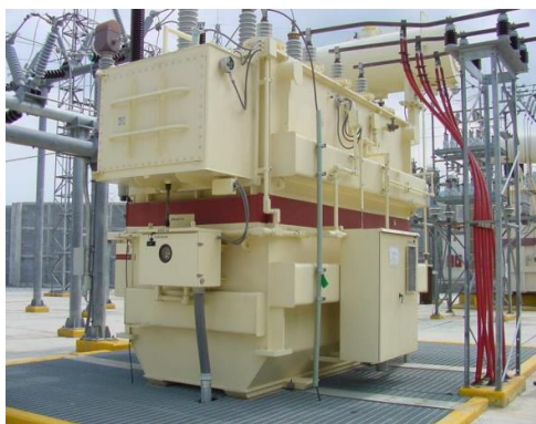
Fig.2.6 Transformador de 18/24/30 MVA, 115/13.2 KV.
