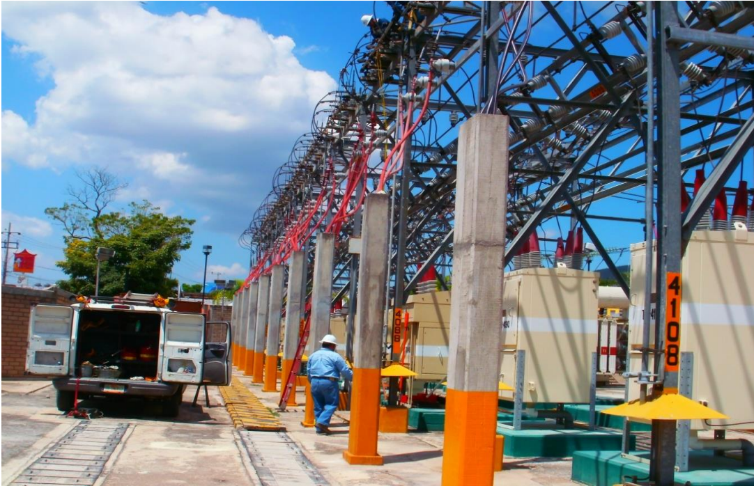
Foto 1.- Subestación Tuxtla Uno con los equipos de protección de cada circuito y su estructura en Media Tensión.
