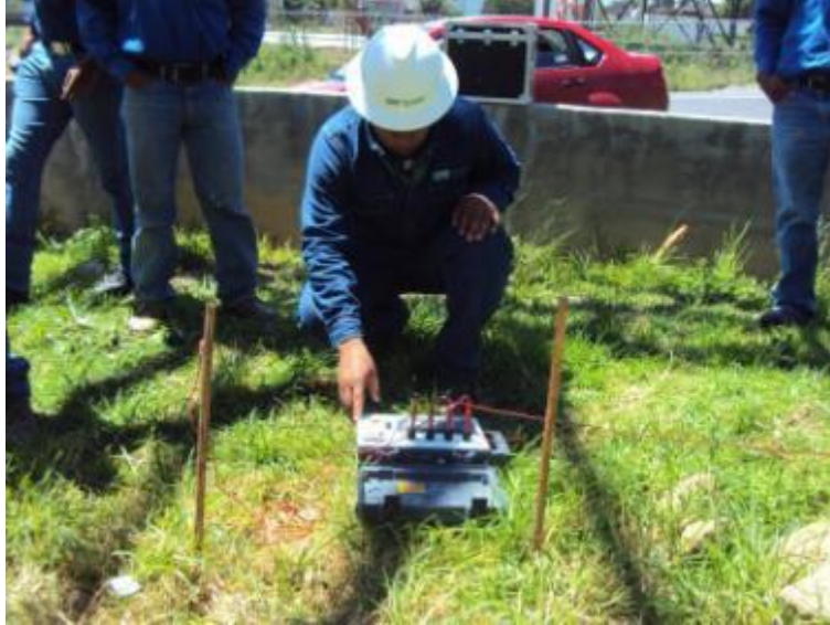
FIG. 28 MEDICION DEL SISTEMA DE TIERRAS EN TORRES.
