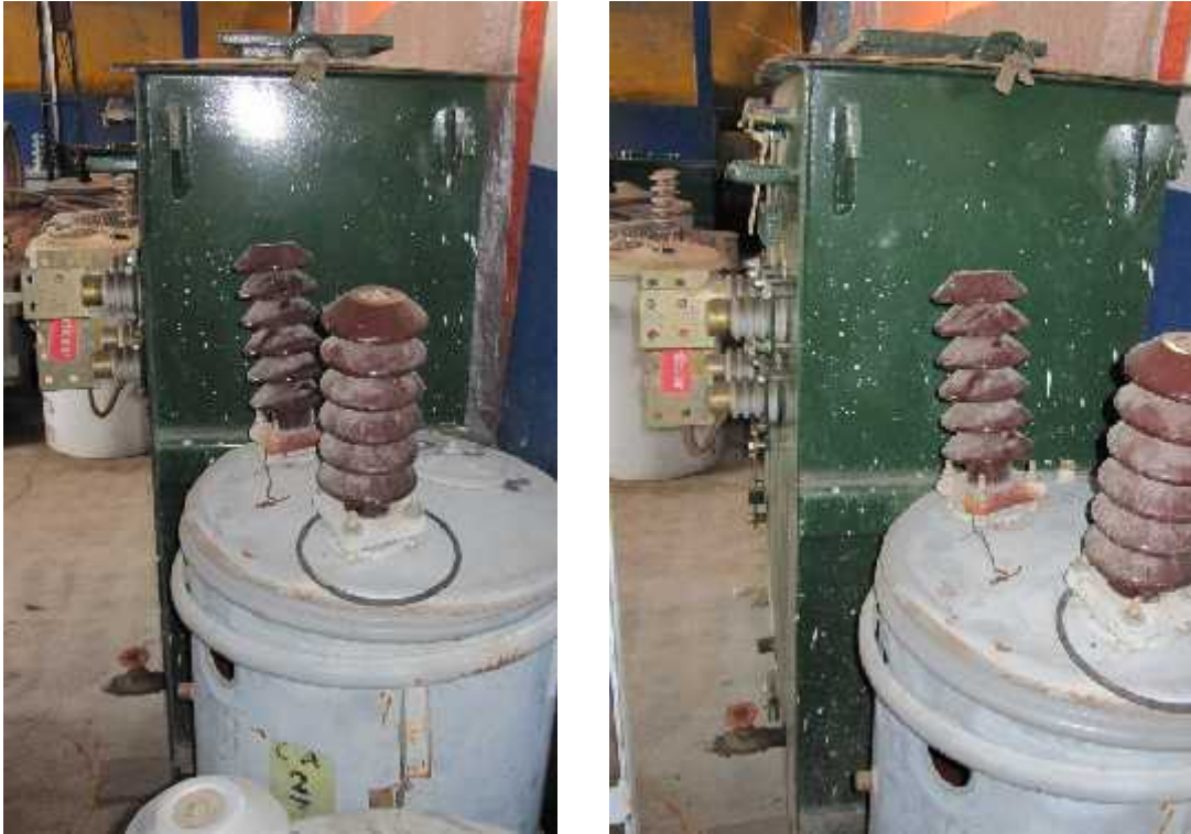
Figuras 3.2. Tanque abombado por causa de una falla de impulso por rayo.
