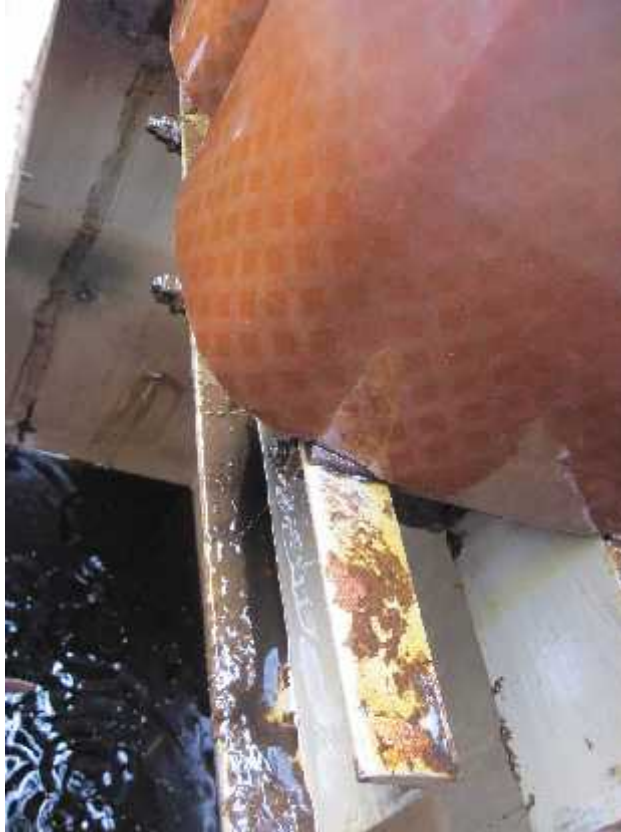
Figura 3.9. Presencia de lodos (sedimentos) en el herraje por humedad contenida en el aceite dieléctrico.
