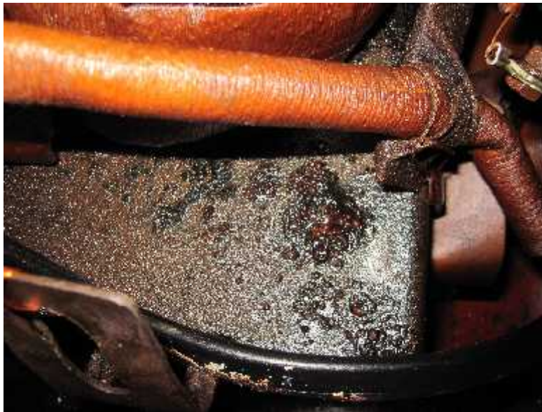
Figura 3.11. Presencia de cobre pulverizado sobre herraje.
