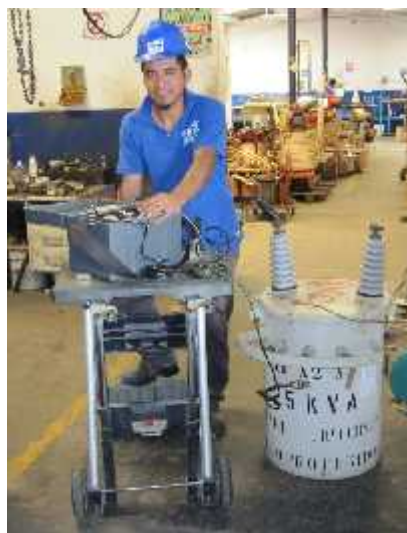
Figuras 3.1.13. Personal de la empresa E.I.M.S.A. realizando pruebas de resistencia de aislamiento (MEGGER).
