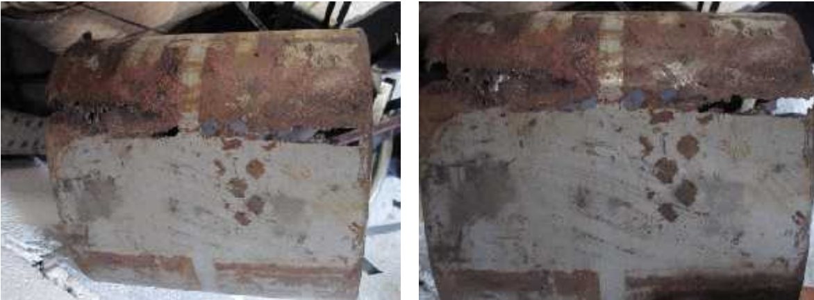
Figura 3.14. Presencia de corrosión y desgaste en lámina de núcleo.
