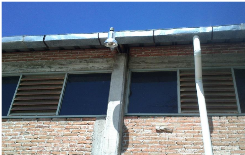
Fig. 3.21 Única luminaria sobre la parte lateral derecha del almacén de producto terminado.
