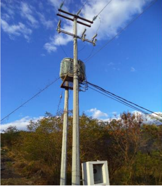
Fig. 3.6 S.E.2, aisladores diferentes, retenida en mal estado, falta de acometida.
