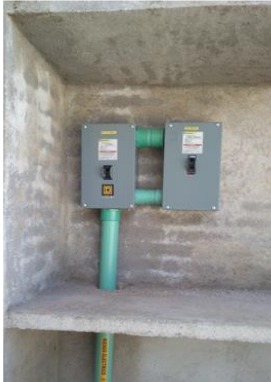
Fig. 4.31 Interruptores termomagnéticos de sala de juntas y principal.
