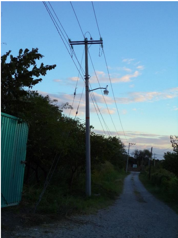
Fig. 3.2 Vista de los postes y estructuras de M.T., desde el predio hacia el punto de conexión.
