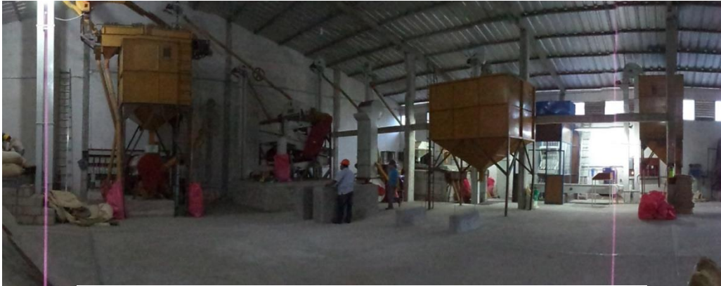
Fig. 3.25 Nave de procesos, línea 1 con respectivas máquinas y equipos.
