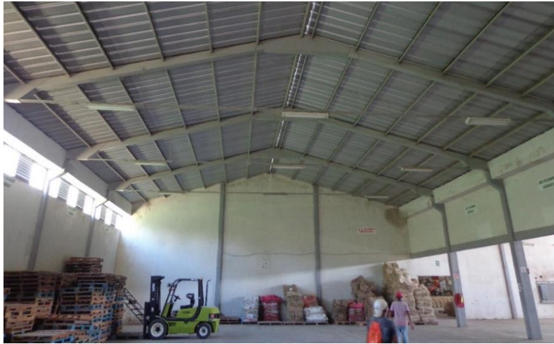
Fig. 3.22 Luminarias en bodega de recepción de materia prima.
