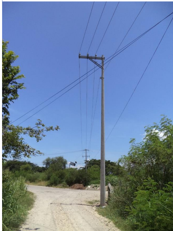
Fig. 4.2 Poste 1 tipo de estructura tipo VD3N, a 40 m del punto de conexión (vista del predio hacia afuera).
