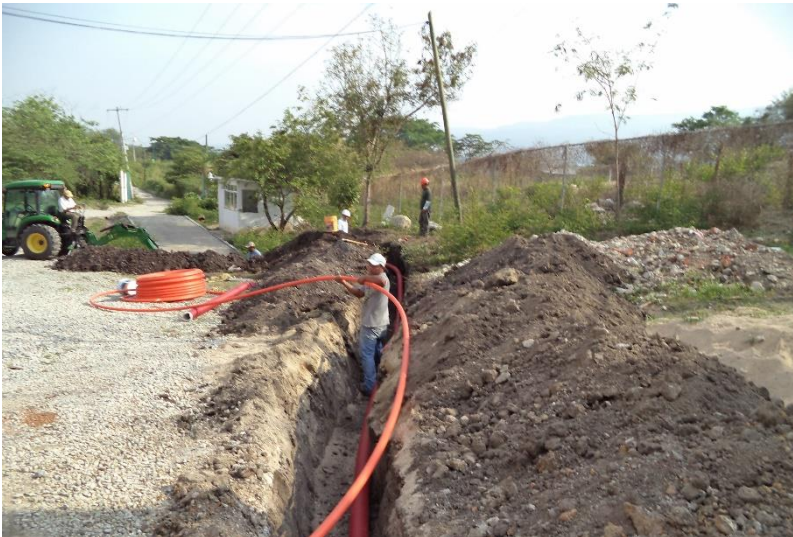
Fig. 4.14 Colocación de tubo PAD corrugado de 103 mm y PAD liso de 32mm, 20.5 m de distancia entre registros.
