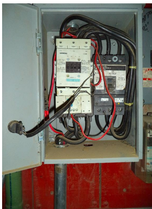
Fig. 3.16 Siemens Sirius 3RT1054-6 Contactor con Módulo de Relé de sobre carga e interruptor automático, equipo de control para línea 1.
