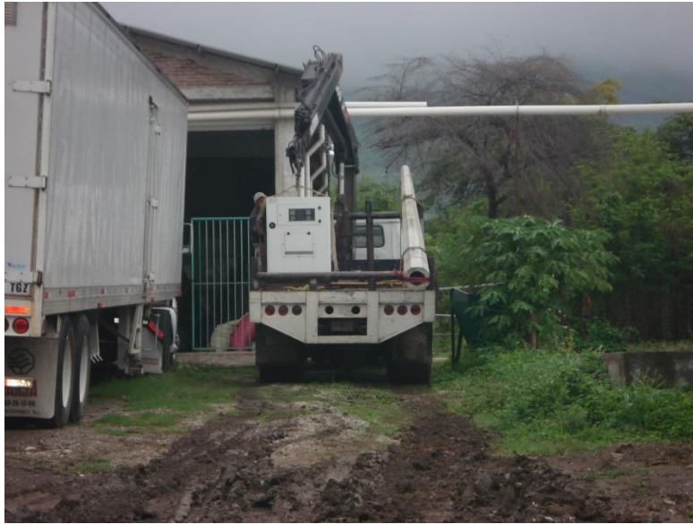
Fig. 4.41 Entrega del CCM Weg y banco de capacitores Arteche.
