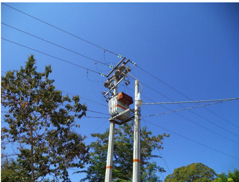
Fig. 3.5 S.E.1, transformador trifásico de 75 KVA con equipos de medición.
