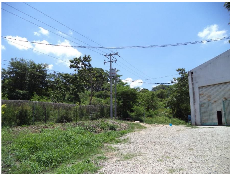
Fig. 4.7 Poste 4, estructura RD3N, con transformador trifásico de 75 KVA (subestación eléctrica tipo poste 1) a 80m del poste 3.
