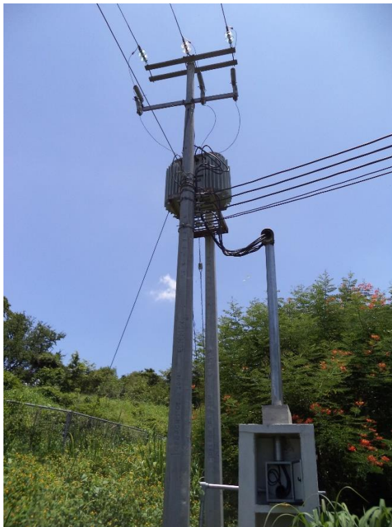
Fig. 4.10 S.E.2 en poste 5, tipo de estructura RDN3, equipos de protección y transformador de 150 KVA a 40 m del poste 4.
