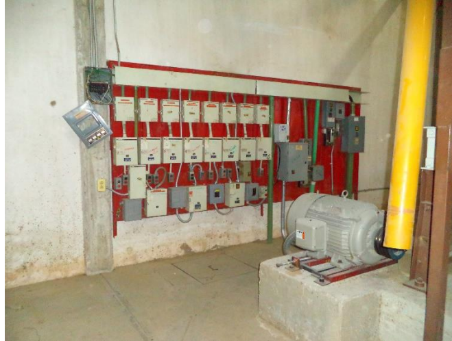
Fig. 3.11 Tablero de control de línea 1, se observan equipos en mal estado debido al rezago de tecnología.
