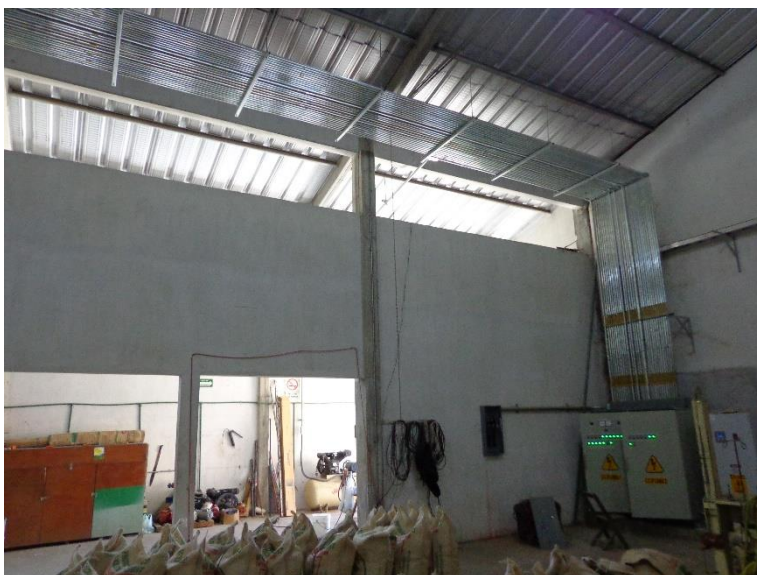
Fig. 4.49 Centro de control de motores en puesta en marcha.
