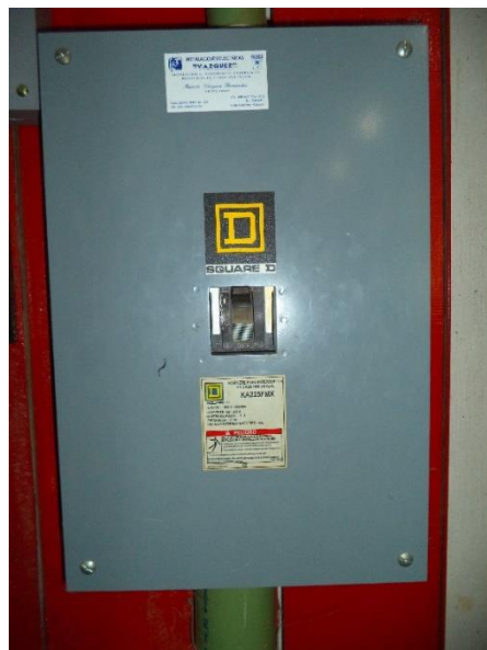
Fig. 3.10 Interruptor general de 3 polos y 225 Amperes, que protege al circuito para los tableros de control, equipos y motores en la nave de procesos.
