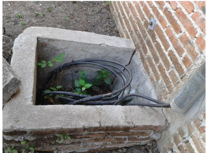
Fig. 3.9 Registro del circuito alimentador, entrada a la nave de procesos.
