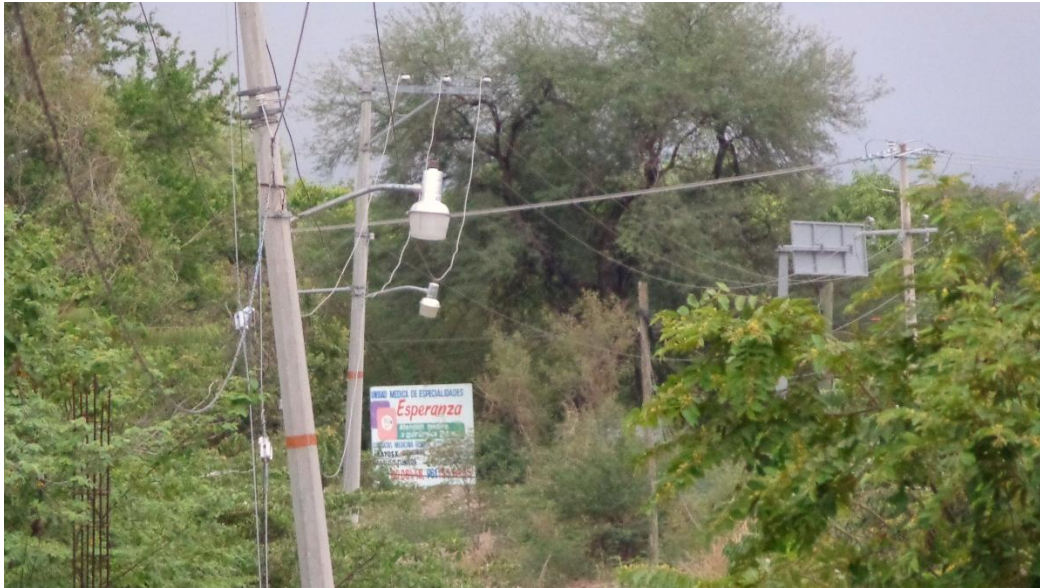
Fig. 3.4 Tensión mecánica débil entre líneas aéreas de media tensión.
