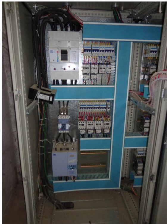
Fig. 4.52 Vista interna del CCM de la línea 1, protección por relevadores y arrancadores a tensión plena y reducida.
