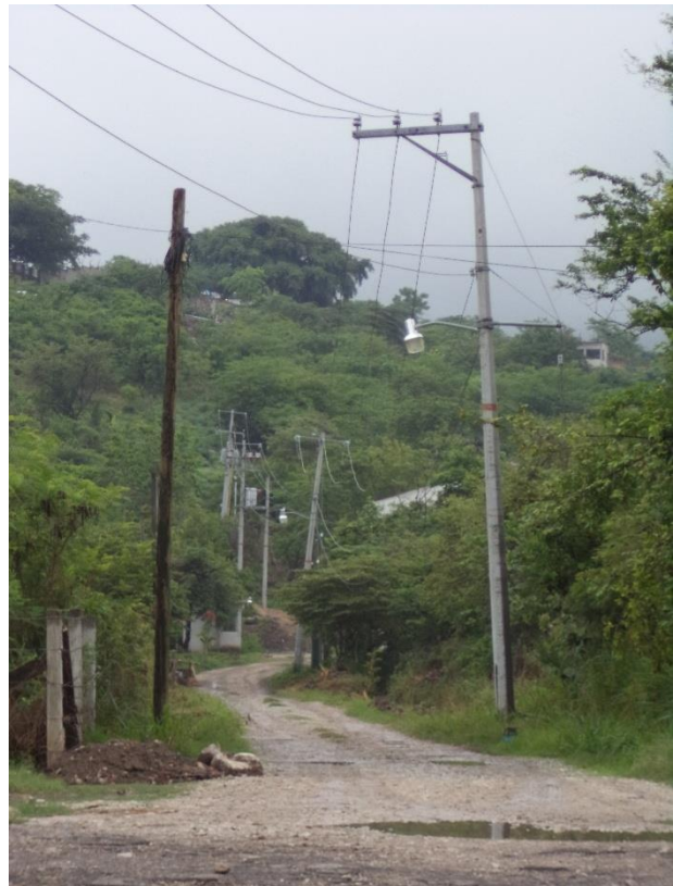
Fig. 3.3 Vista de los postes y estructuras de M.T., desde el punto de conexión hacia las subestaciones.
