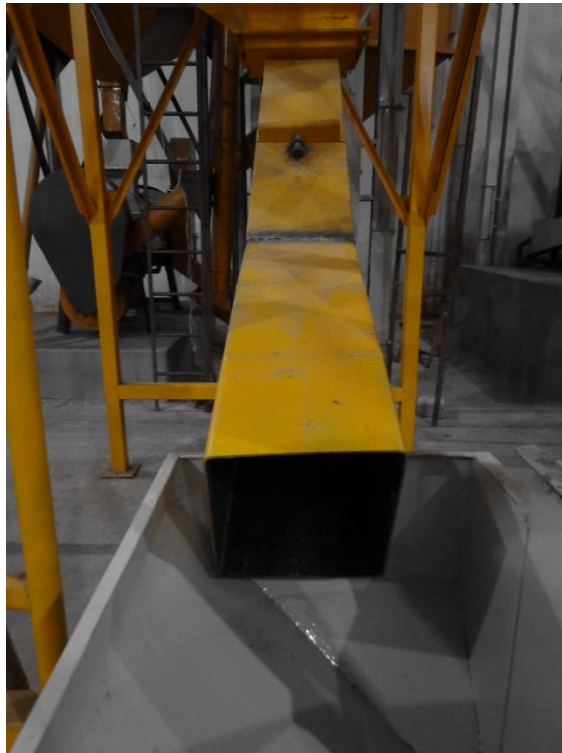
Fig. 4.39 Válvula de dos vías salida hacia el elevador numero 10.
