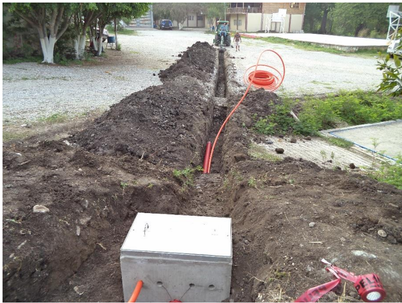
Fig. 4.15 Registro baja tensión tipo banqueta (RBTB-1) 02.
