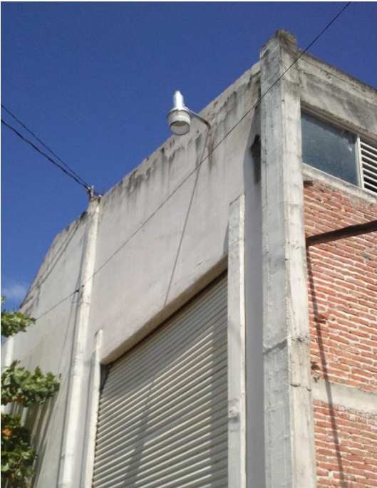
Fig. 3.17 Luminaria instalada en el área de nave de procesos y oficina general.
