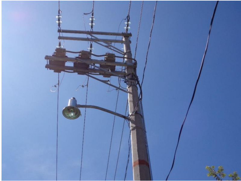
Fig. 4.5 Poste 3, nueva ubicación de los equipos de medición.
