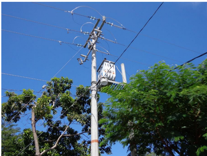
Fig. 4.8 S.E.1., equipos de protección y transformador 75 KVA.
