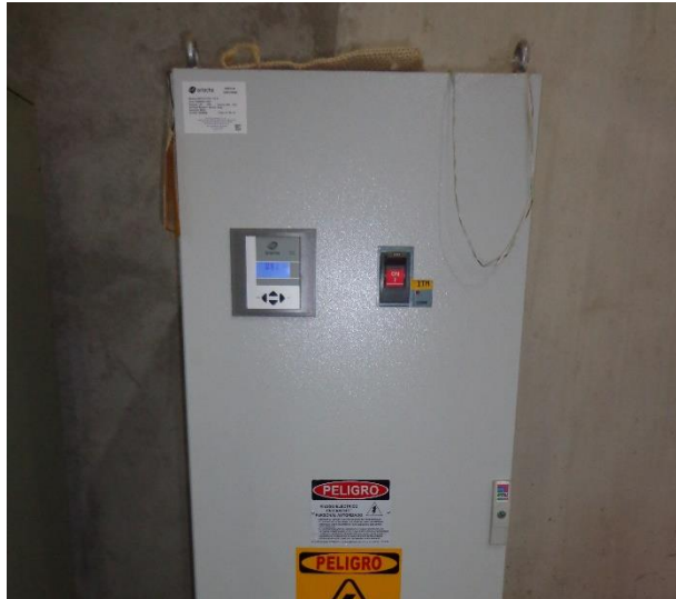
Fig. 4.55 Banco de capacitores Arteche 110 KVar, modelo CAB 0110 236 11P N1.
