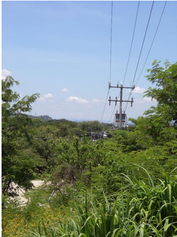
Fig. 4.9 Subestación eléctrica 1 vista desde la S.E.2.
