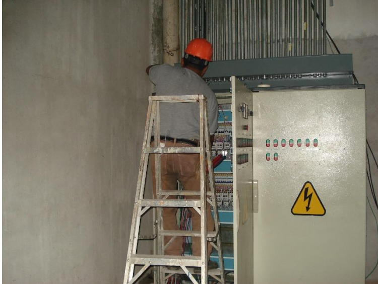
Fig. 4.45 Conexiones en barras hacia tableros del CCM.
