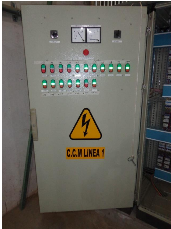
Fig. 4.51 CCM Línea 1 con 18 pulsadores arranque / paro, voltímetro y amperímetro analógicos.
