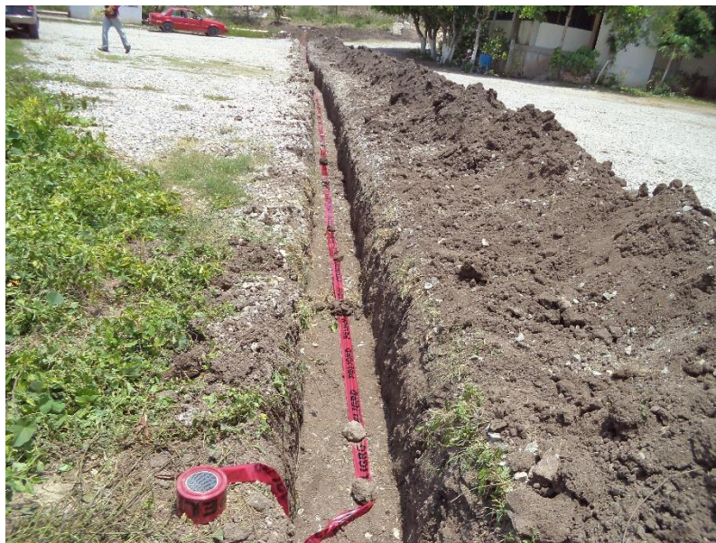
Fig. 4.20 Señalización con banda de “peligro”, después de puesta de tubos y compactado de suelo RBTB-1 02 a RBTB-1 03.
