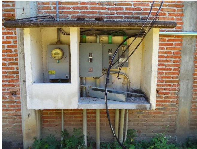
Fig. 3.9 Medidor y gabinetes con interruptores principales de los circuitos que alimenta la S.E.1.
