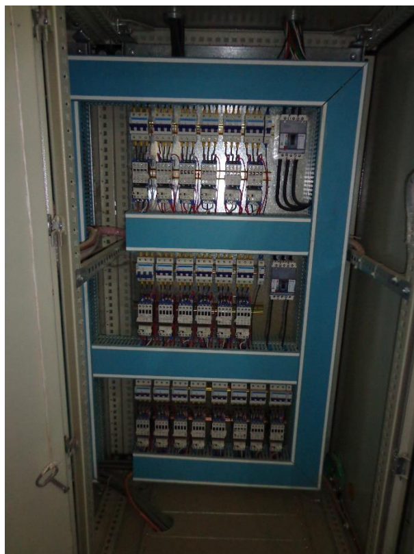
Fig. 4.54 Vista interna del CCM de la línea 1, protección por relevadores y arrancadores a tensión reducida.
