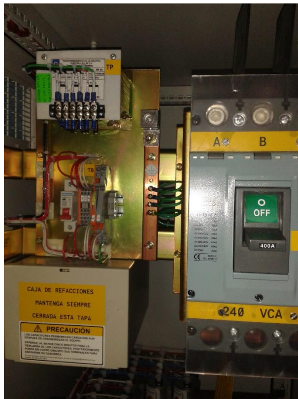
Fig. 4.58 Interior del banco de capacitores, se observa el interruptor principal además del TP.
