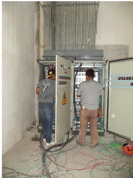
Fig. 4.46 Conexiones de control: protecciones, arrancadores, pulsadores y paros de emergencia.
