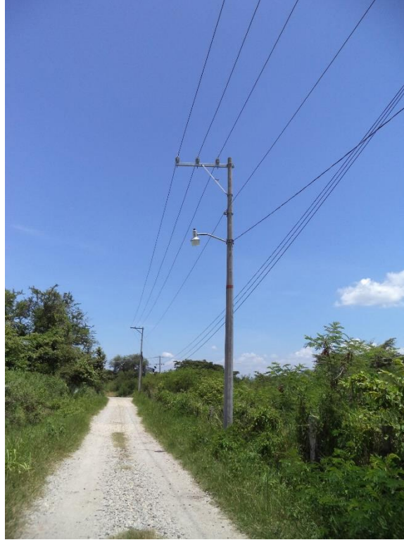
Fig. 4.3 Poste 2, estructura tipo VS3N, a 50m del poste 1.
