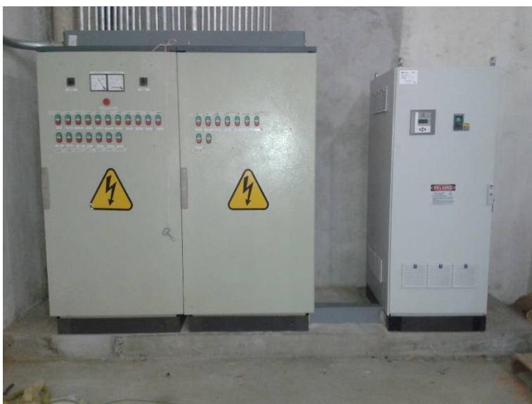
Fig. 4.50 CCM Weg y banco de capacitores Arteche.
