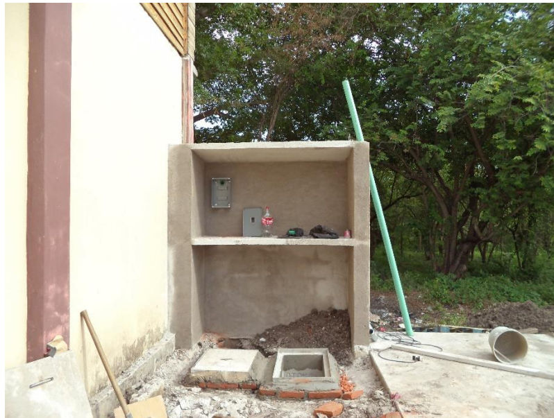
Fig. 4.30 Murete de interruptores 02.
