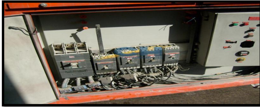
FIG. 68 EQUIPO VIEJO Y DAÑADO
