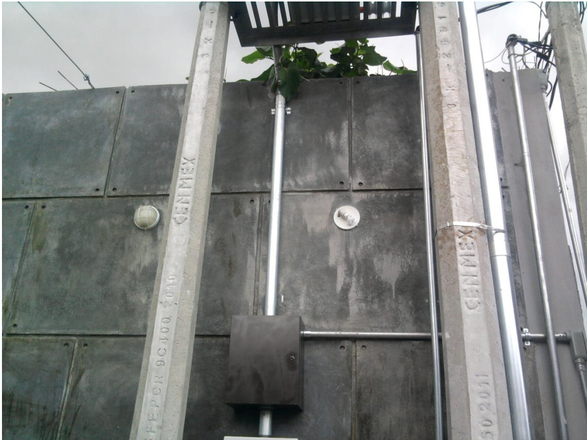
FIG 2.20 TABLERO DE CONTROL GENERAL.
