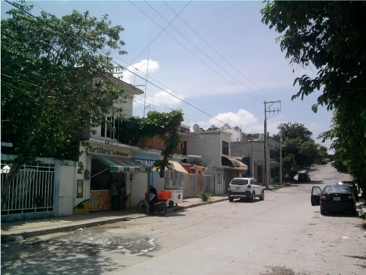
FIG 2.21 VISTA DE LEJOS DONDE PASAN LAS LINEAS DE 13200 V EN LAS CRUCETAS DEL POSTE INSTALADO.
