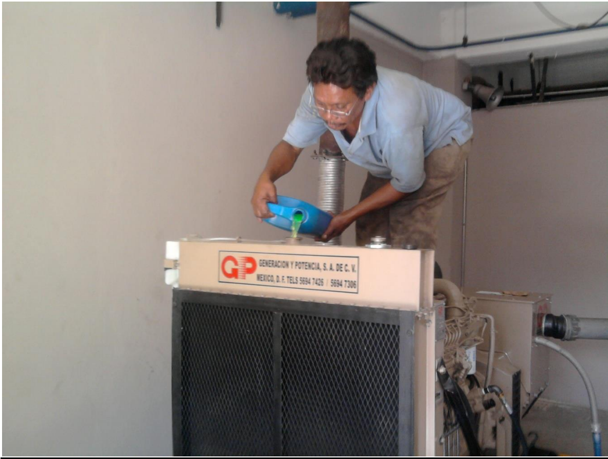
FIG 3.17 ANTICONGELANTE COLOCADO A LA PLANTA.
