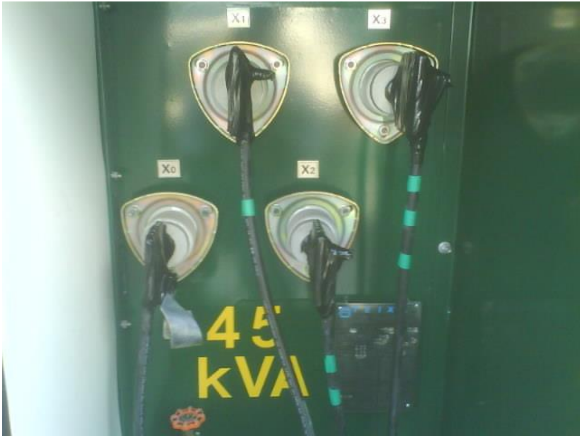
FIG 1.11 OTRA VISTA DEL TRANSFORMADOR COLOCADO.
