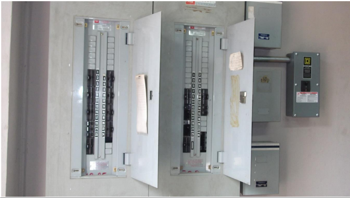
FIG 3.3 TABLEROS DE CONTRL GENERAL QUE OPERA LA MAQUINA ESTACIONARIA CUANDO SE INTERRUMPE LA ENERGIA SUMINISTRADA POR LA CFE.
