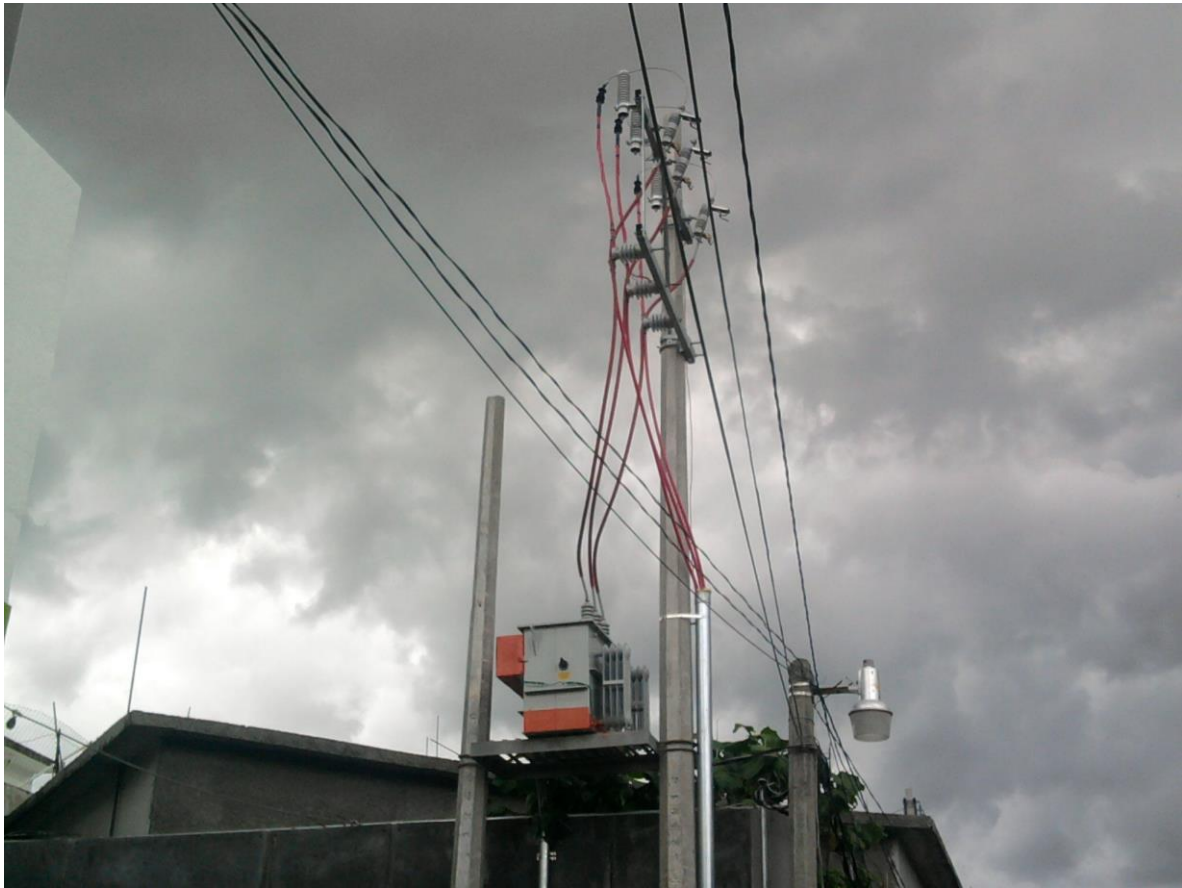
FIG 2.19 AQUÍ SE MUESTRAN LAS LINEAS DE ALTA POTENCIA QUE LLEGAN AL TRANSFORMADOR.
