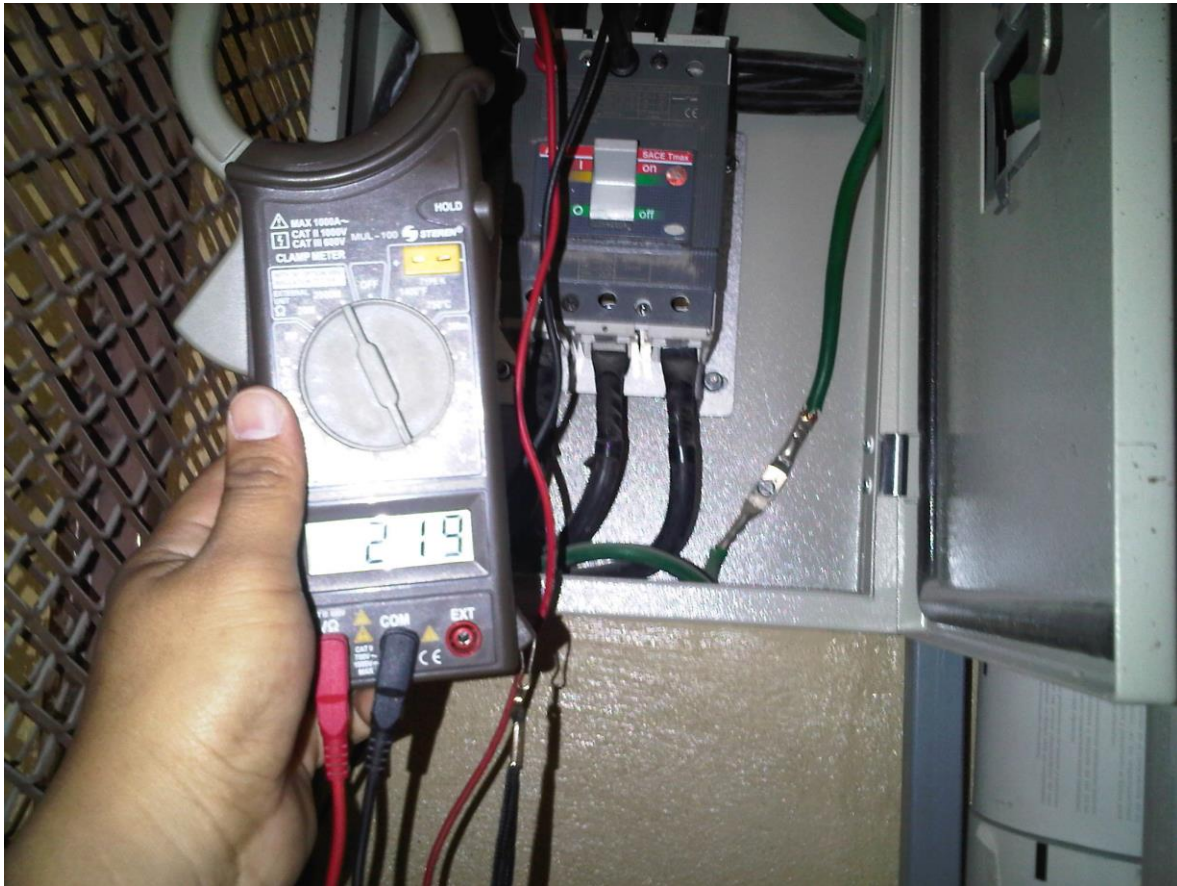
FIG 4.3 MEDION CON EL AMPERIMETRO PARA CORROBORAR LA ALIMENTACION EN ESTE CASO ES A 220 V Y EL EMPERIMETRO NOS MARCA 219 POR LO TANTO ES BUENA LA MEDICION.
