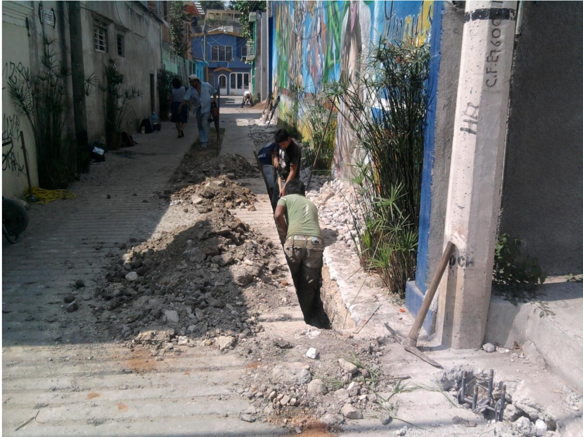
FIG 2.4 PARA LA ESCAVACION SE UTILIZO MATERIAL COMO LA ROMPEDORA HILTI. PICO, PALA, EL CABAHOYOS Y EL ESMERIL INDUSTRIAL
