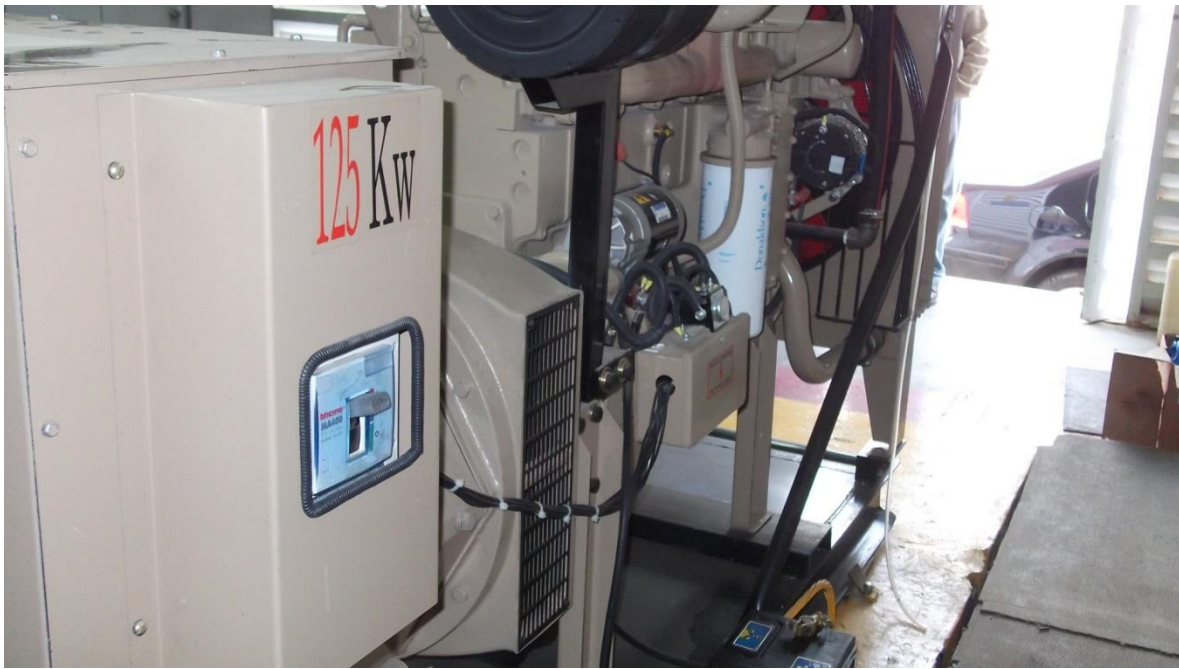
FIG 3.5 POTENCIA DE LA PLANTA DE EMERGENCIA
