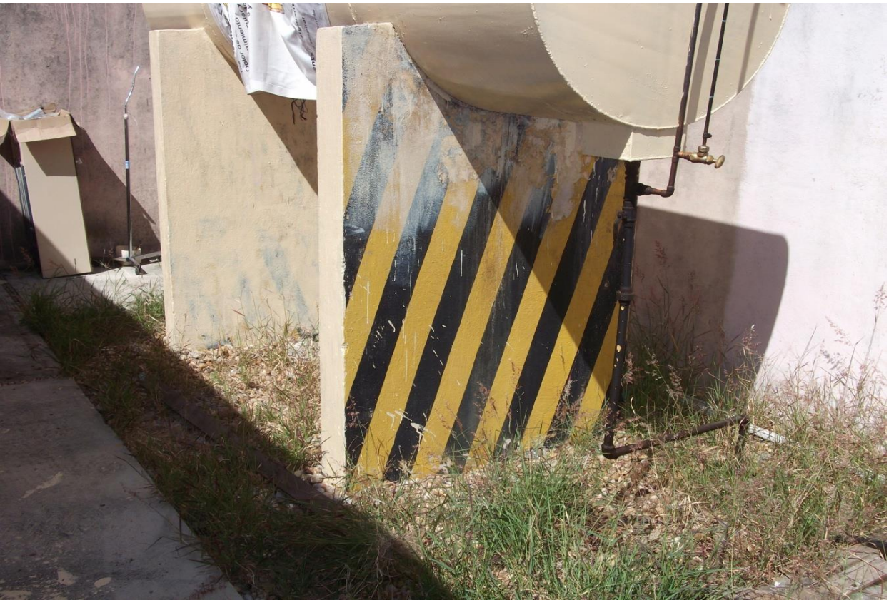
FIG 3.7 ASI SE ENCONTRABA EL TANQUE DE DIESEL ANTES DEL MANTENIMIENTO
