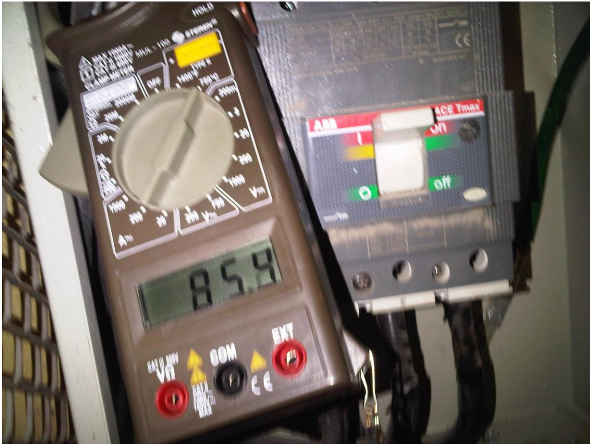
FIG 4.4 EN ESTE CASO MEDIMOS UNA LINEA Y UNA TIERRA DEBERIAMOS TENER UNA ALIMENTACION DE 110 V PERO NOS MARCA FUERA DE LO INDICADO HABIENDO QUE CHECAR POR QUE HAY UN BAJO VOLTAJE.
