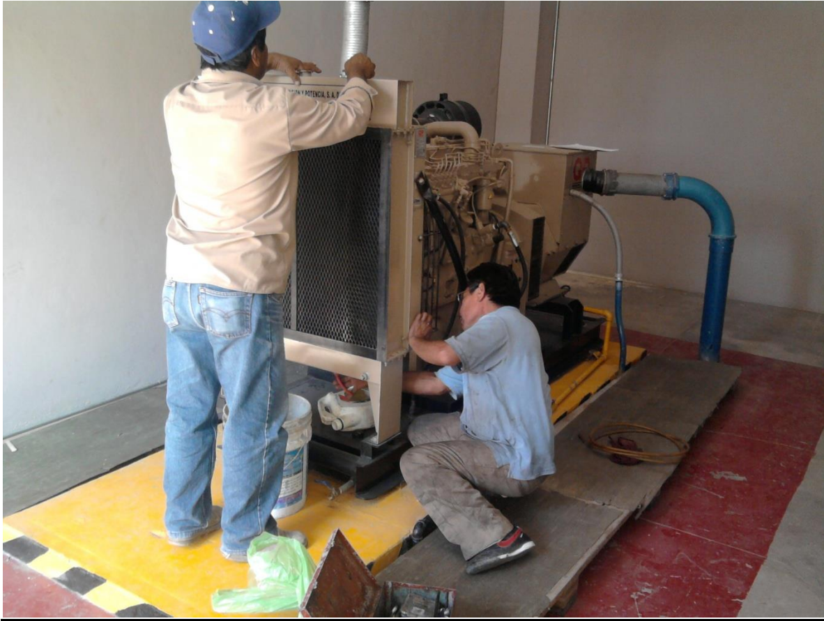
FIG 3.12 MANTENIMIENTO AL RADIADOR DE LA MAQUINA ESTACIONARIA TIRANDO EL ANTICONGELANTE SUCIO.
