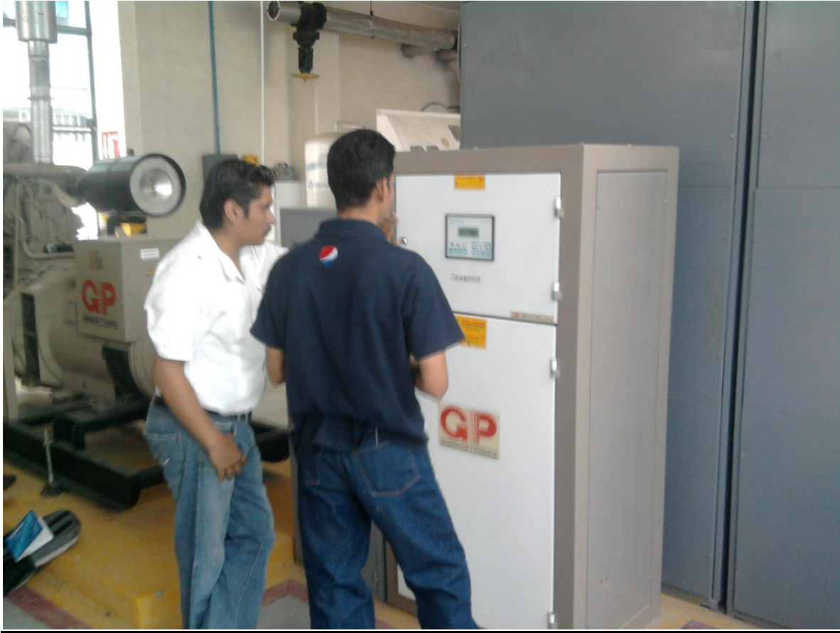
FIG 3.21 AJUSTE Y PROGRAMACION DEL PLC PARA EL PROXIMO MANTENIMIENTO.
