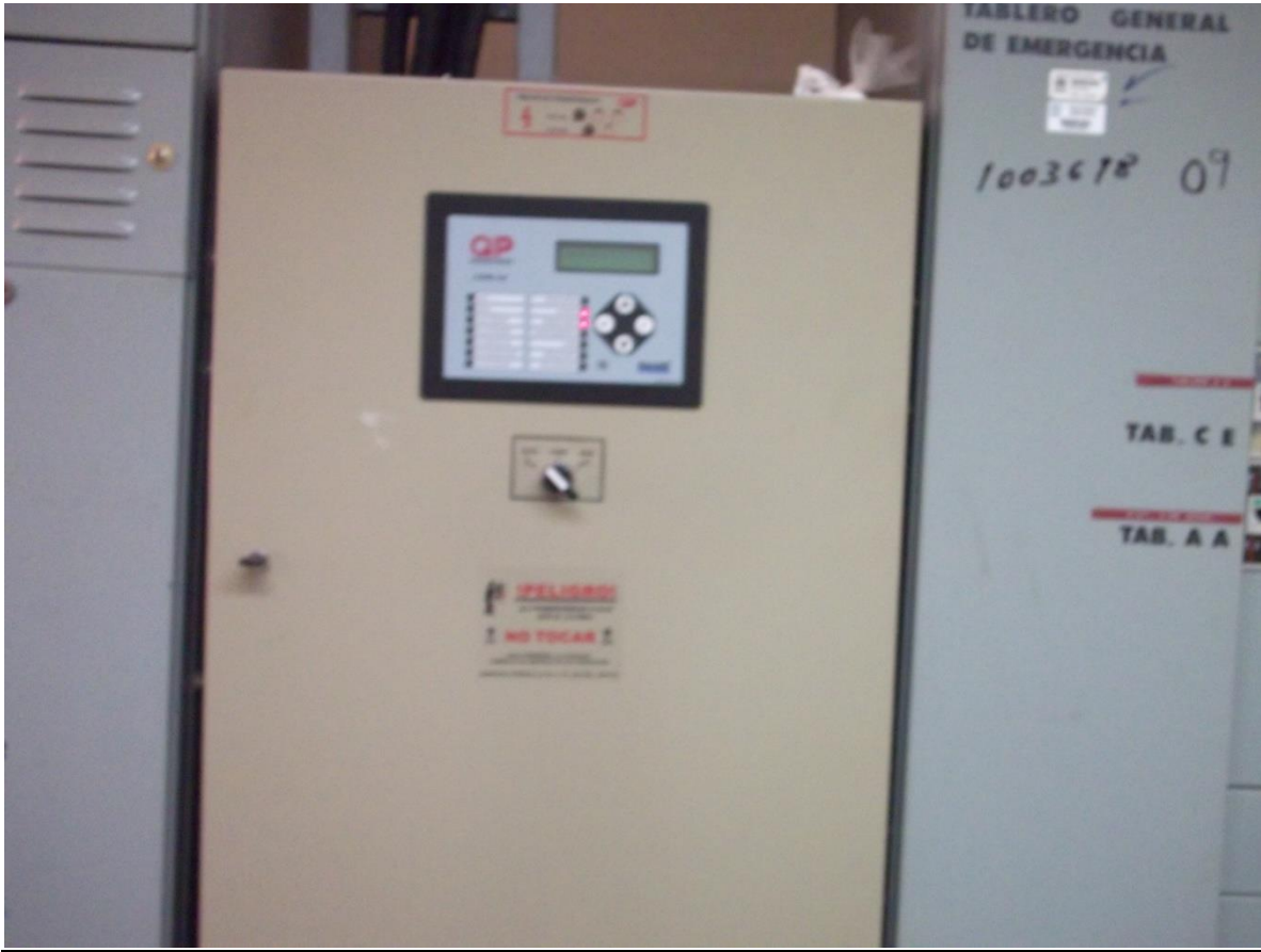
FIG 3.2 PLC QUE OPERA A LA PLANTA DE EMERGENCIA.
