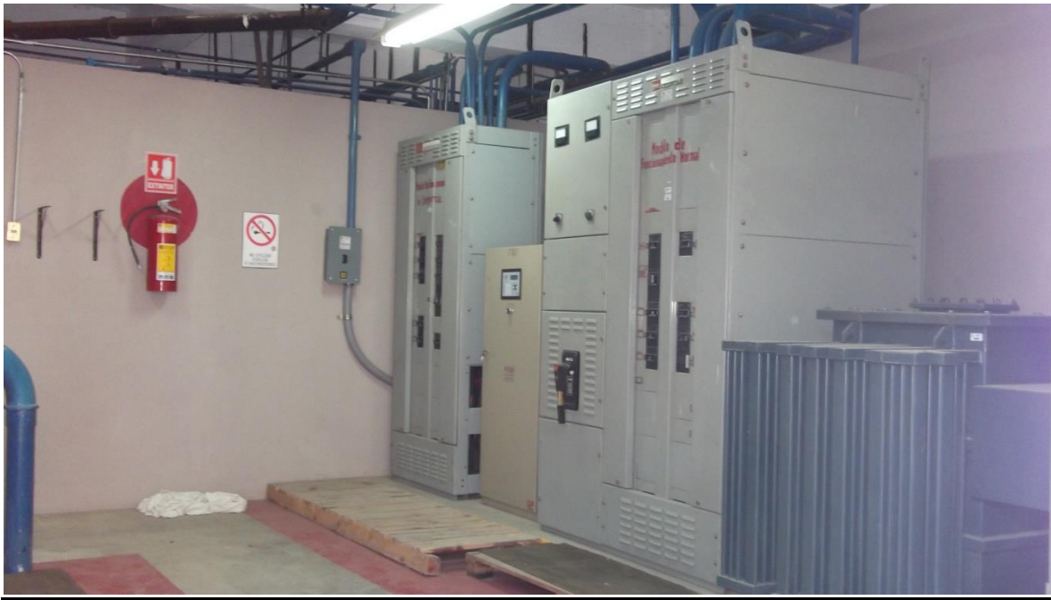
FIG 3.10 TRANSFORMADOR DE 300 KVA Y CONTRL DE LA PLANTA DE EMERGENCIA
