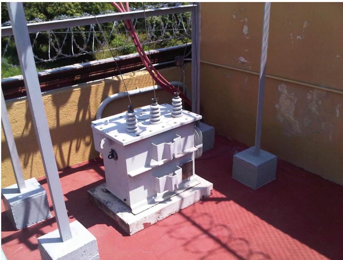
FIG 4.7 TRANSFORMADOR QUE MANTIENE AL EDIFICIO DONDE SE REQUIERE EL SISTEMA DE TIERRA.
