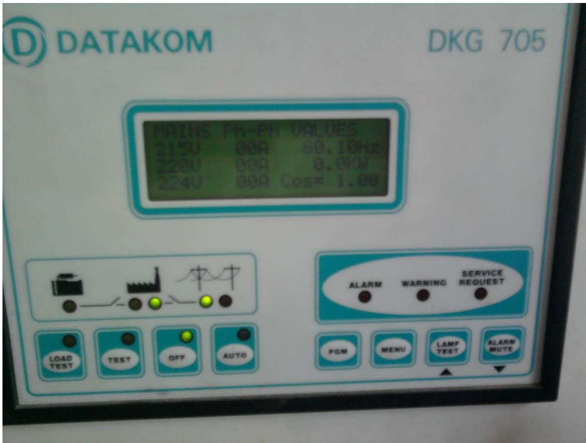
FIG 3.20 PLC QUE CONTROLA A LA PLANTA DE EMERGENCIA, LOS BOTONES VERDES INDICAN EL BUEN FUNCIONAMIENTO DE LA PLANTA DE EMERGENCIA DE ESTA MANERA COMO SE MUESTRA EN LA FIG. DEBEN DE ESTAR LAS LUCES DE LO CONTRARIO SI APARECE UNA LUZ ROJA INDICA QUE LA MAQUINA NECESITA MANTENIMIENTO, YA QUE EL TIEMPO SE PROGRAMA EN DICHO PLC QUE DEBE DE SER CADA 6 MESES
