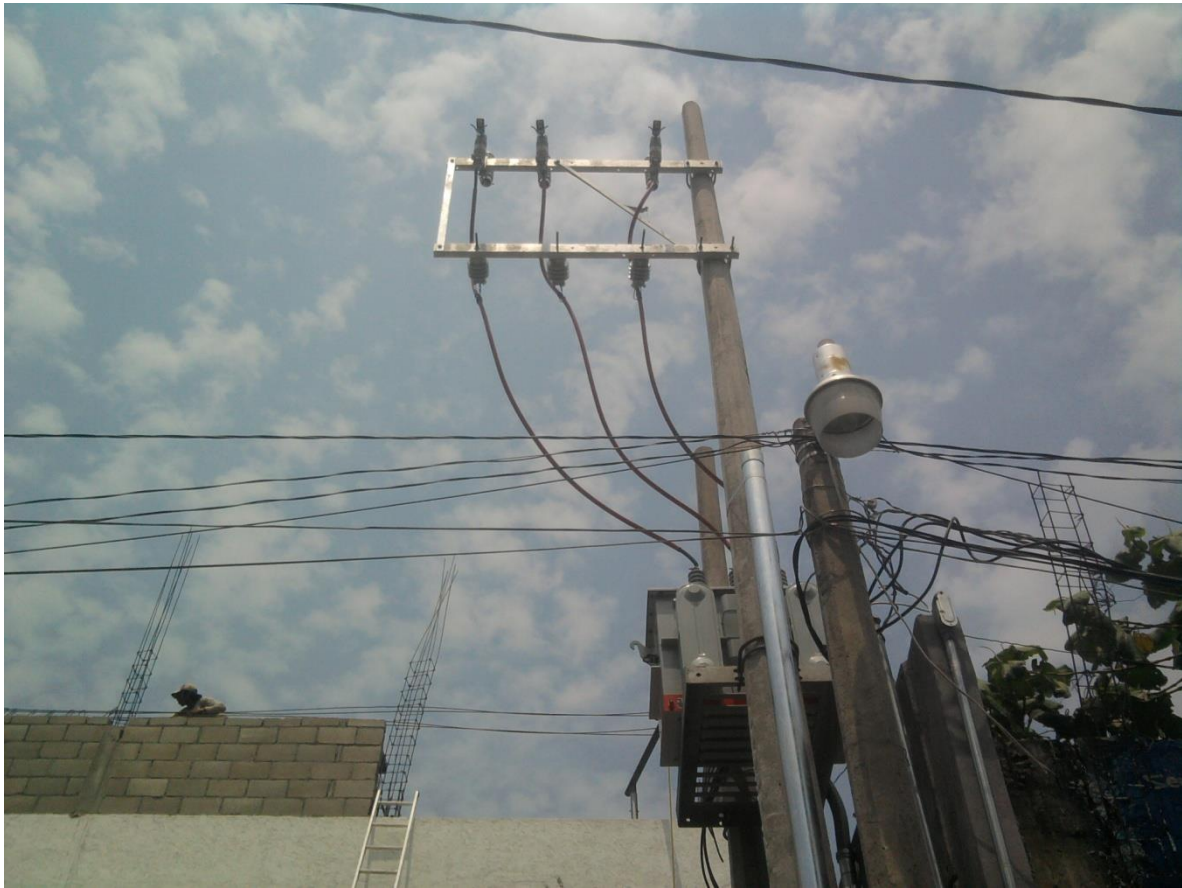
FIG 2.17 LINEAS DE ALTA POTENCIA BAJANDO AL TRANSFORMADOR.
