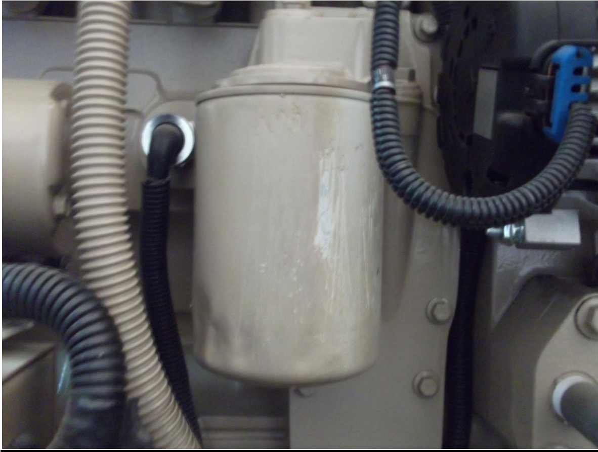
FIG 3.11 FILTRO DE COMBUSTIBLE DAÑADO QUE SE CAMBIO
