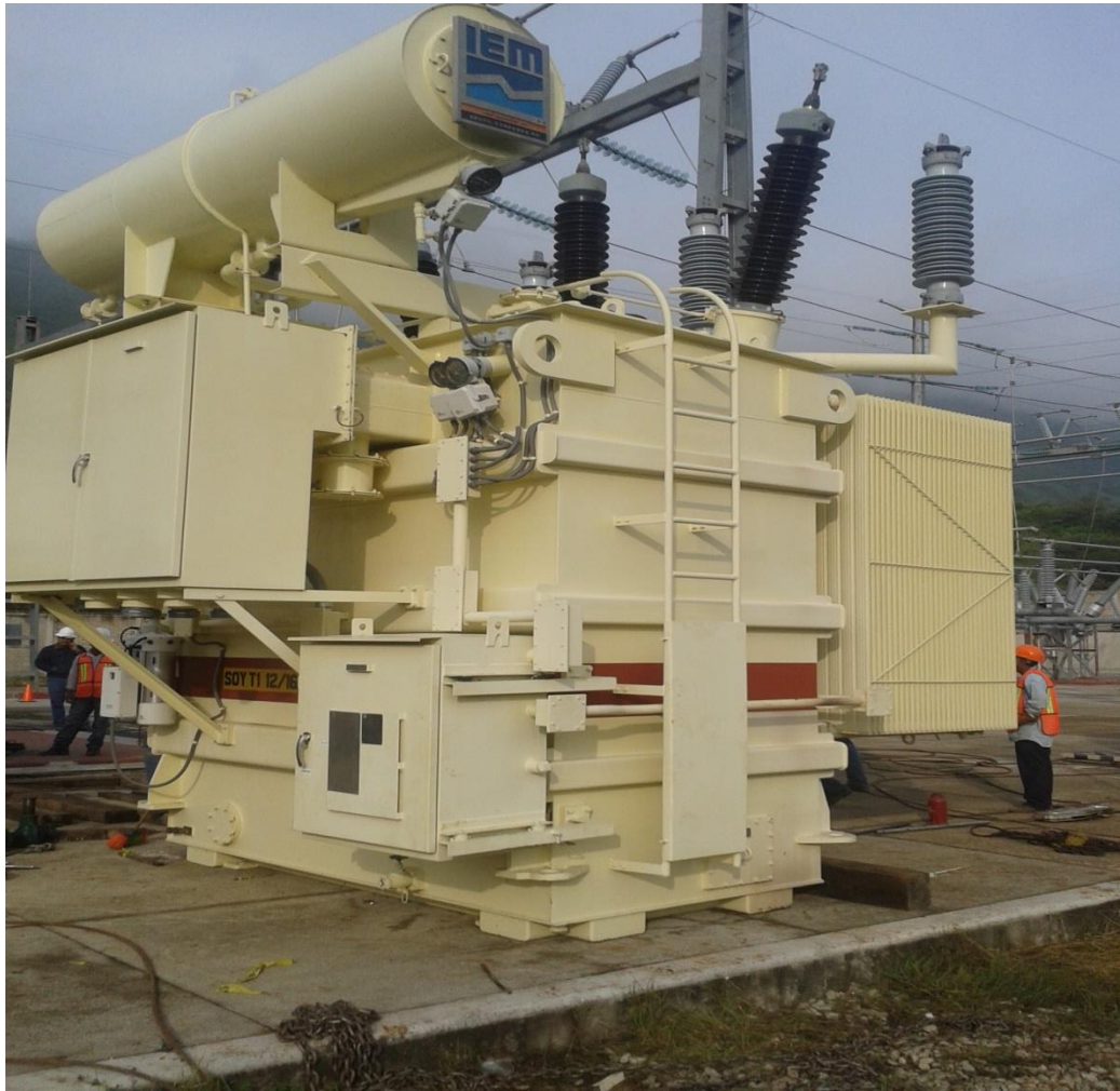
Fig. 3.1 Foto de transformador que se colocara en la Subestación Bochil.
