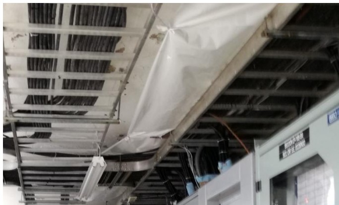
Fig. 3 Techo en mal estado, tiene filtraciones.
