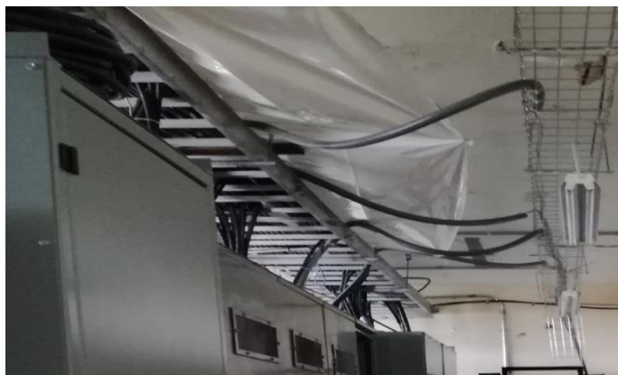
Fig. 4 Techo en mal estado
