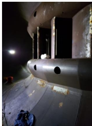
Imagen 37 - Caracol de la turbina del generador síncrono No. 8.
