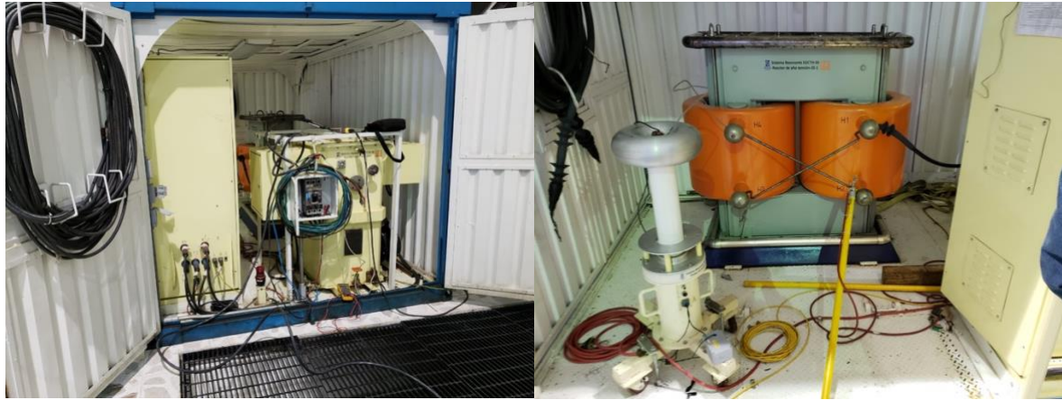
Imagen 24 - Transformador elevador y reactor utilizados en pruebas.
