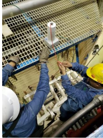
Imagen 26 - Conexión del equipo de medición de reactancias a las fases.
