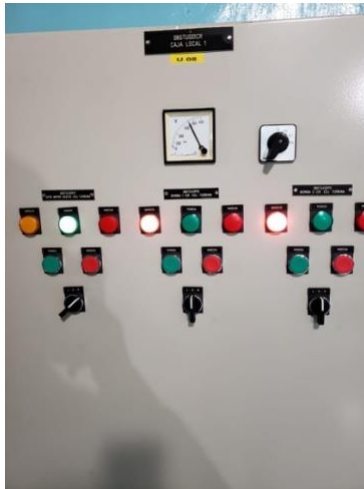
Imagen 21 - Tablero de auxiliares.
