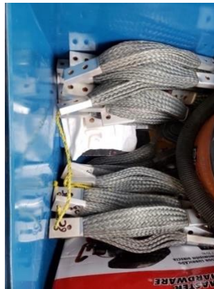
Imagen 14 – Trenzas del generador después de la limpieza.
