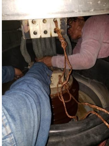
Imagen 20 - Desconexión de trenzas de las boquillas del transformador de potencia.
