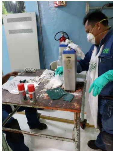
Imagen 31 - Limpieza de baterías y barras de conexión del banco de CD.
