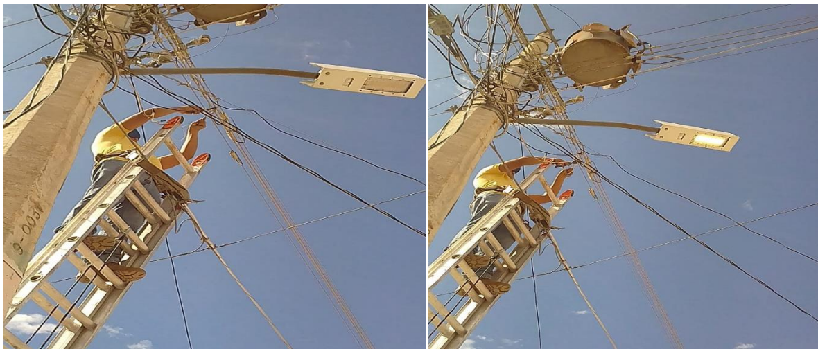
Fig. 52. Lámpara rehabilitada LED 2
