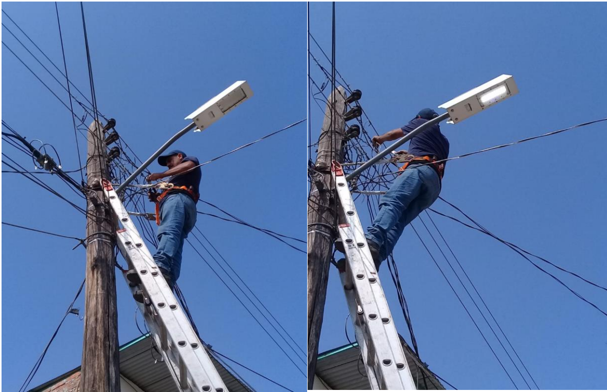
Fig. 51. Lámpara rehabilitada LED 1
