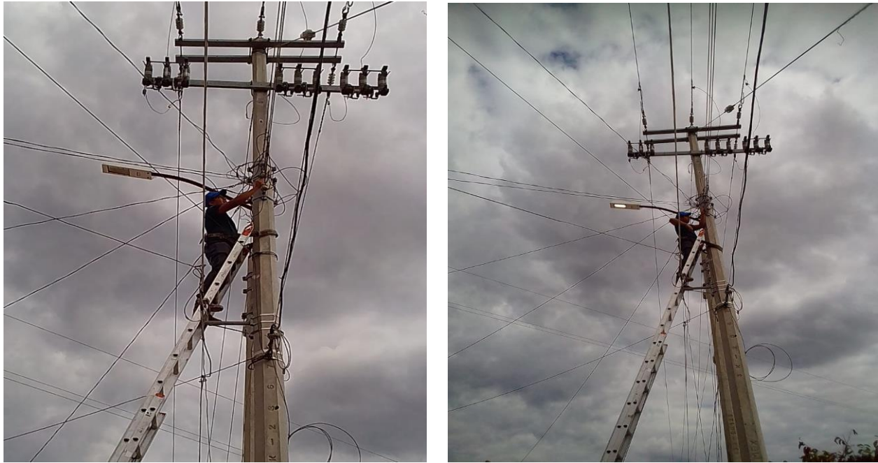
Fig. 53. Lámpara rehabilitada LED 3
