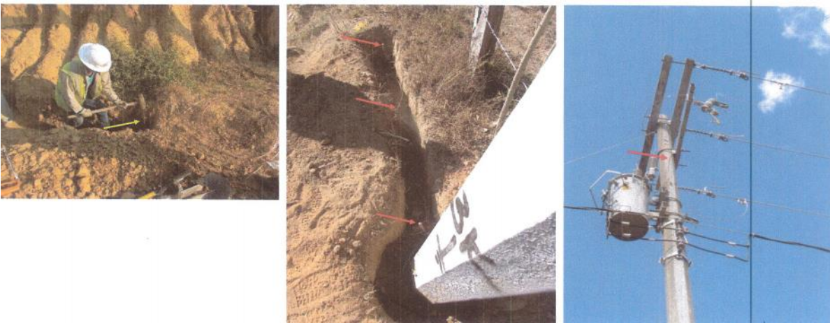
Fig. A.13 Colocación de y conexión de tres electrodos de puesta a tierra para transformador.
