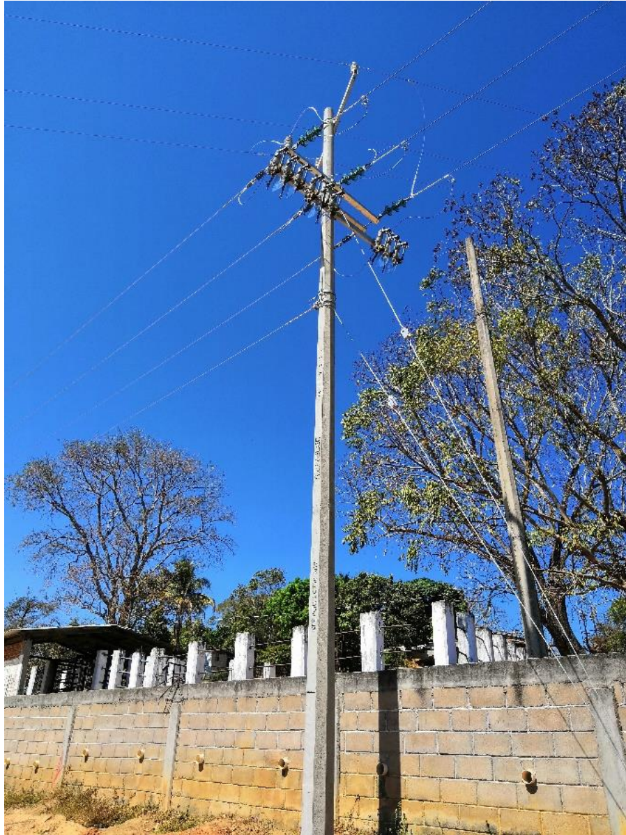
Fig. A.7 Vestido de Estructura de un Poste en M.T. Tipo TS30, tres Fases para 13.2 KV, Con CCF de triple disparo.
