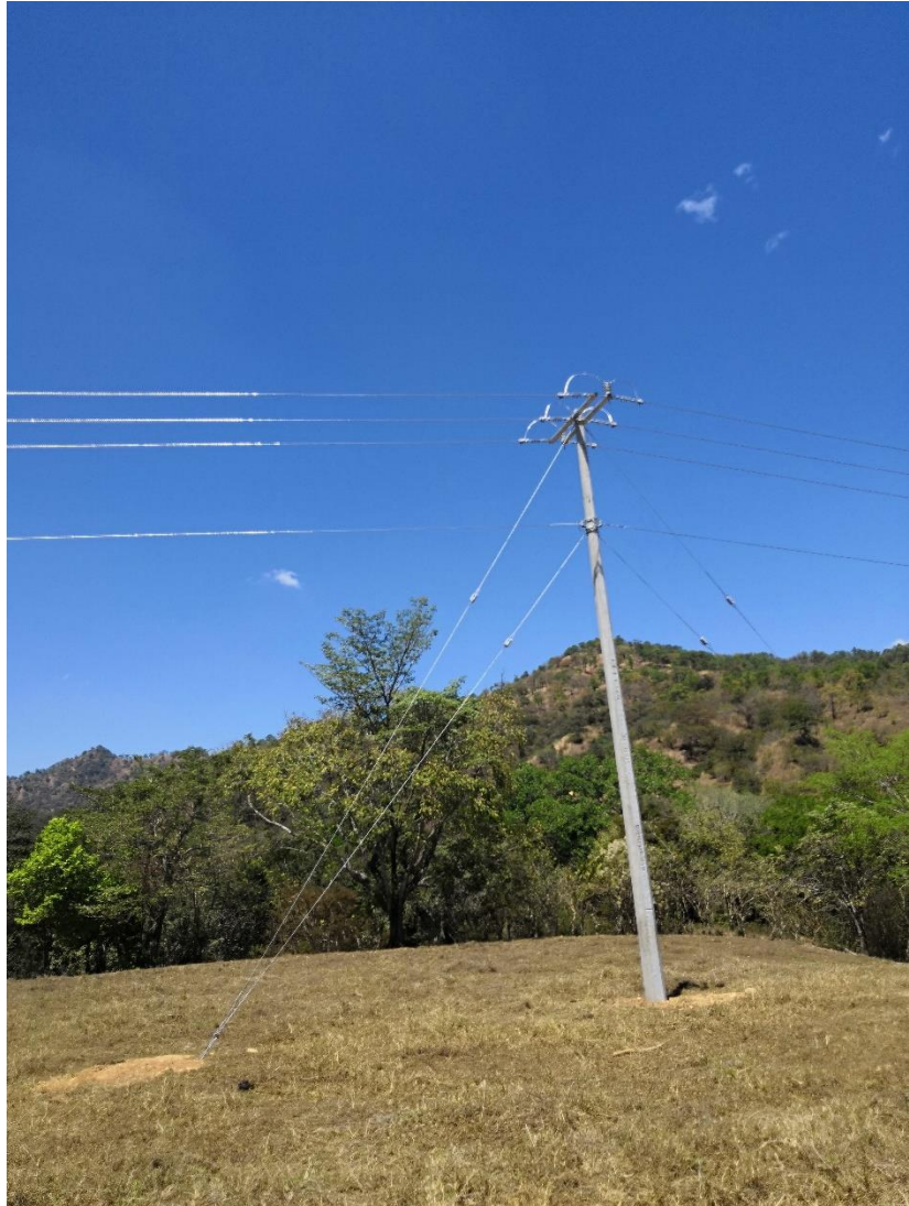
Fig. A.9 Vestido de Estructura de un Poste en M.T. Tipo TD30, tres Fases para 13.2 KV.
