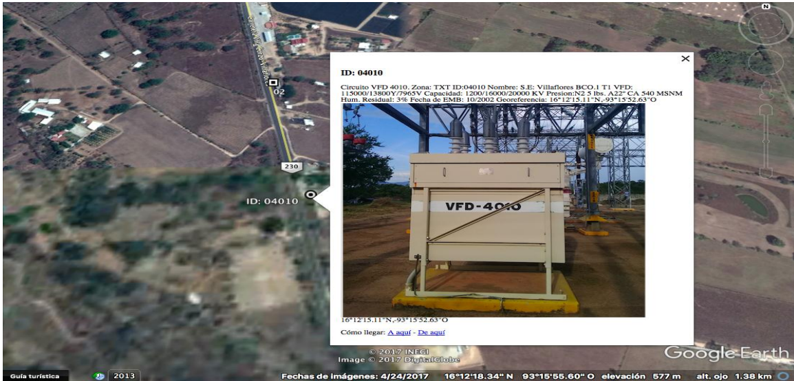
Figura No. 3 Interruptor VFD-4010, Subestación. Google Earth.
