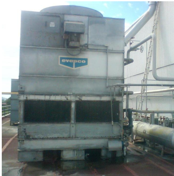
Figura 3.6 Torre de enfriamiento
