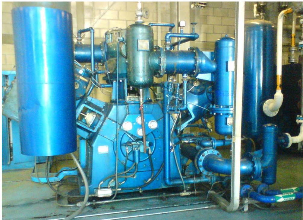
Figura 3.3 Compresor de Alta Presión Bellis & Morcom
