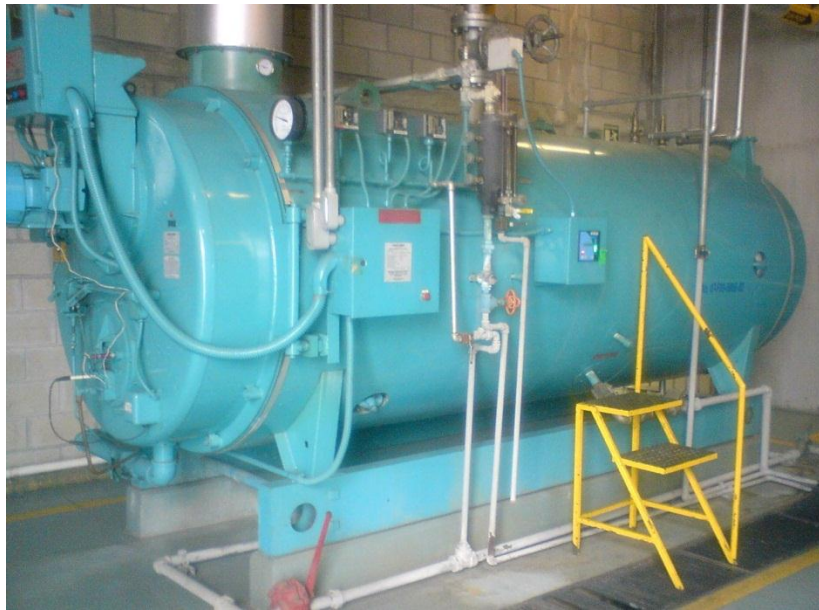
Figura 3.17 Caldera de vapor
