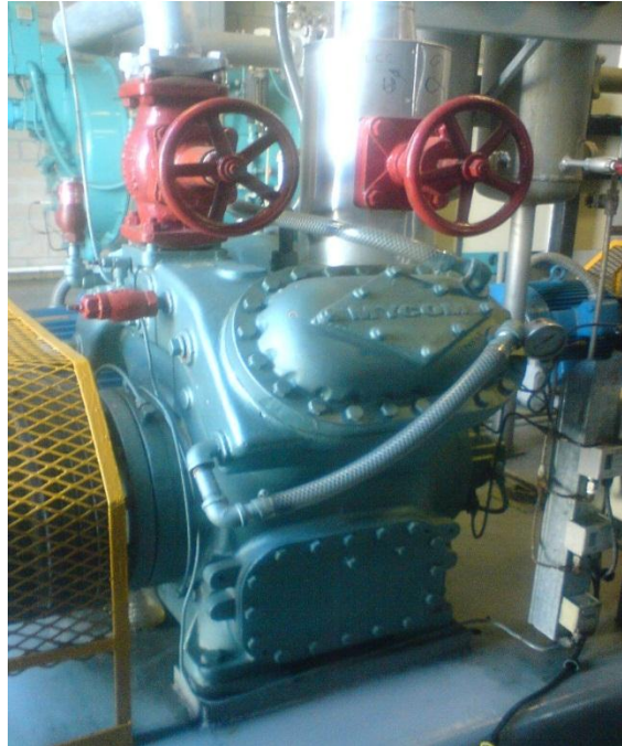
Figura 3.8 Compresor de amoniaco para el sistema de refrigeración
